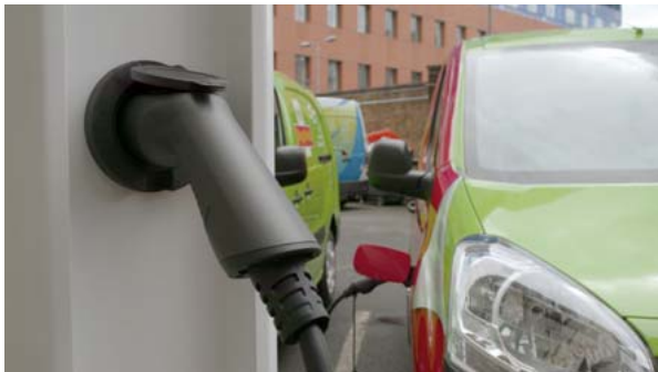
図5 | 充電設備で充電中のEV
