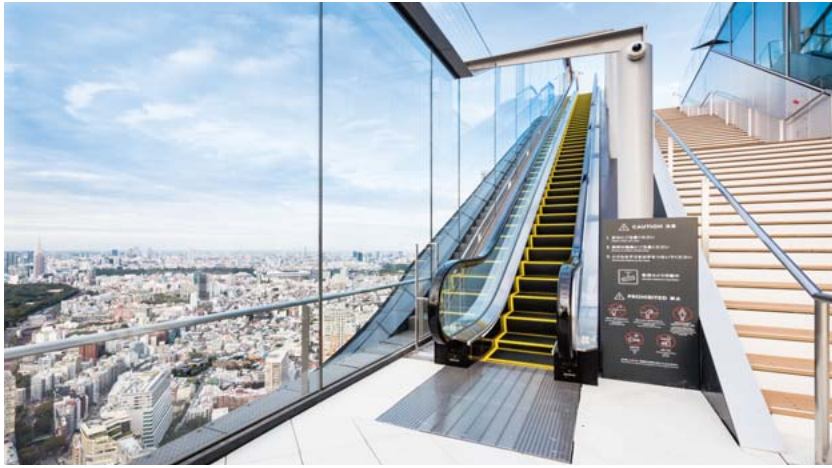
7 渋谷スクランブルスクエアの屋上展望空間に設置された屋外型エスカレーター
