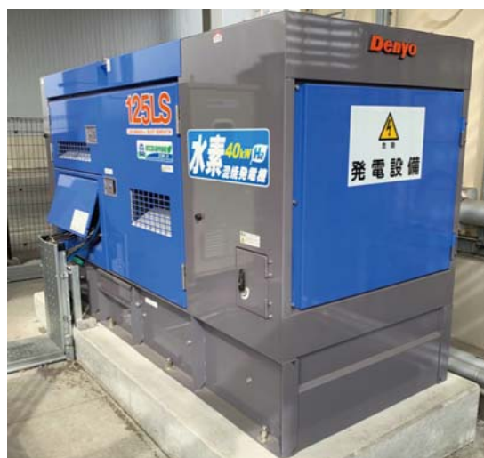
5 水素混焼発電機
