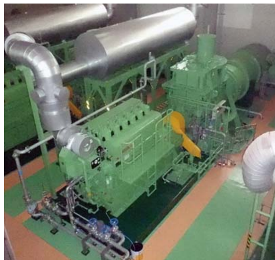
2 省スペース化したエンジン建屋内
