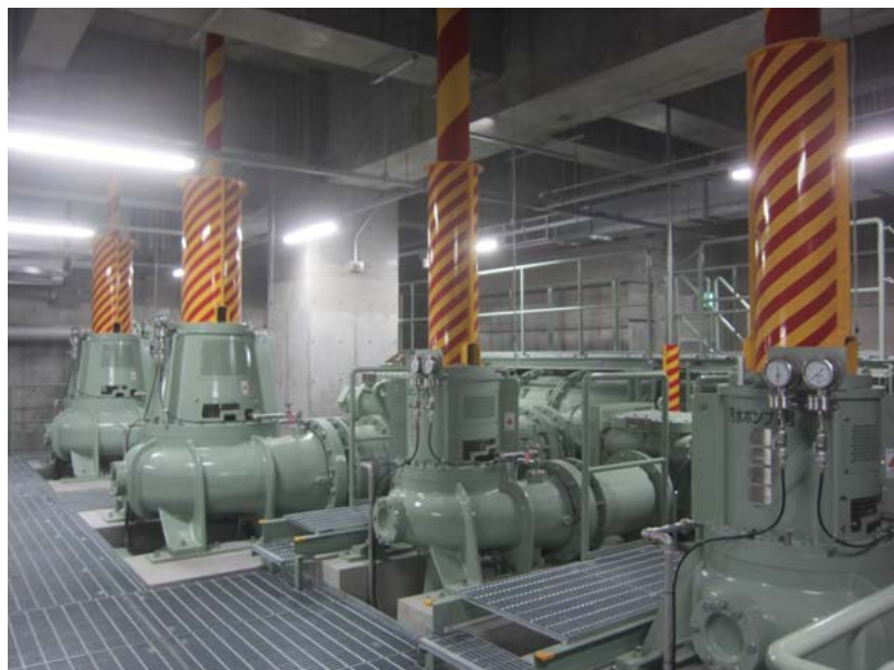
2 銭瓶町ポンプ所ポンプ室
