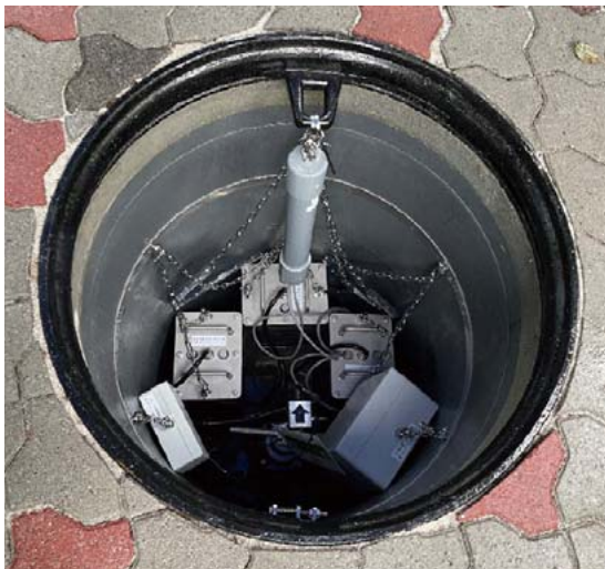
11 流量計室 (内径600 mm) に設置した流量監視装置
