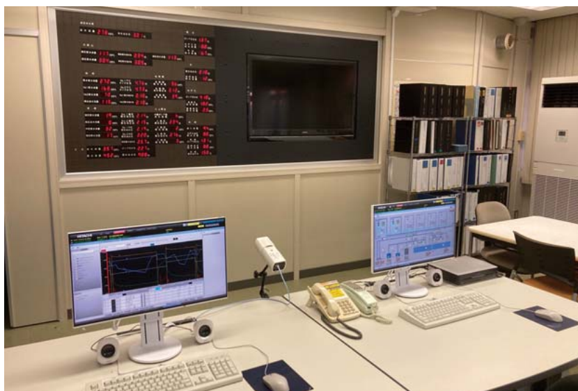
1 山形県東根市役所 水道施設中央監視制御設備
