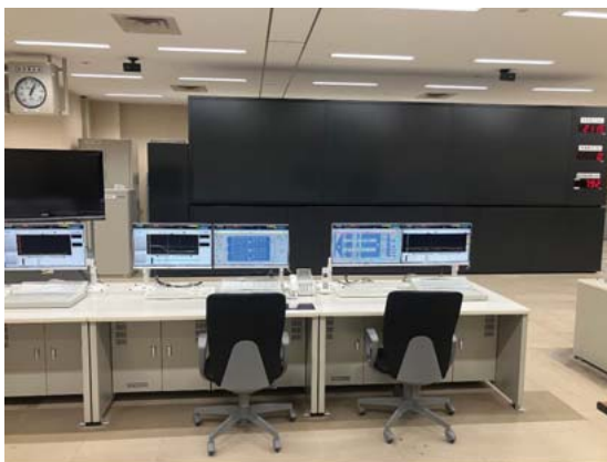
3 中川水再生センター遠方監視制御設備
