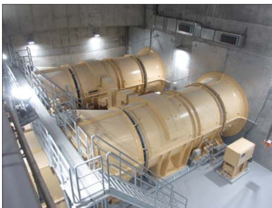
3 築地換気所納め排風機（動翼可変軸流ファン）2台
