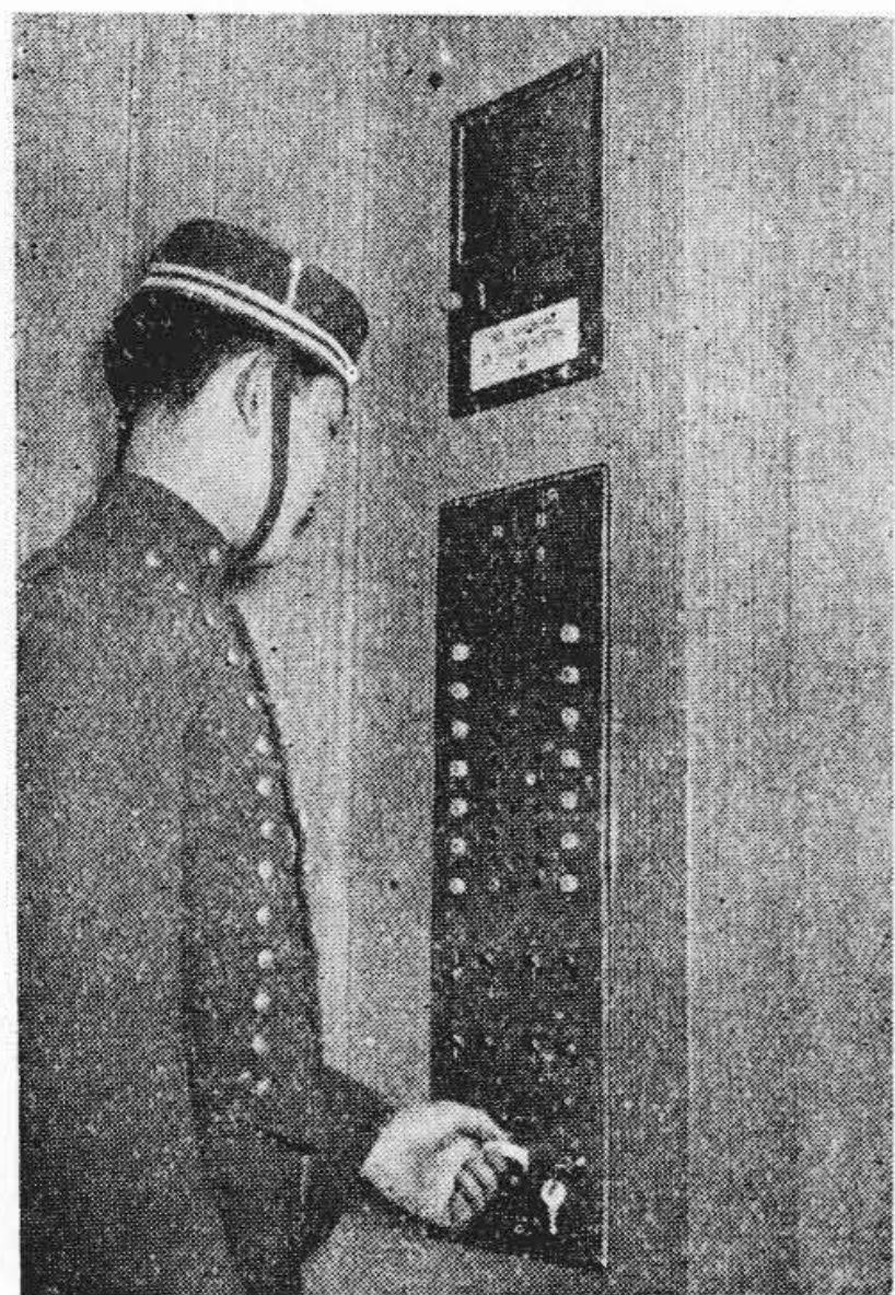
第 9 図 運 転 操 作 盤 (日活国際会館日立エレベータ) Fig. 9. Operating Board (Hitachi Elevator for Nikkatsu International Building)
