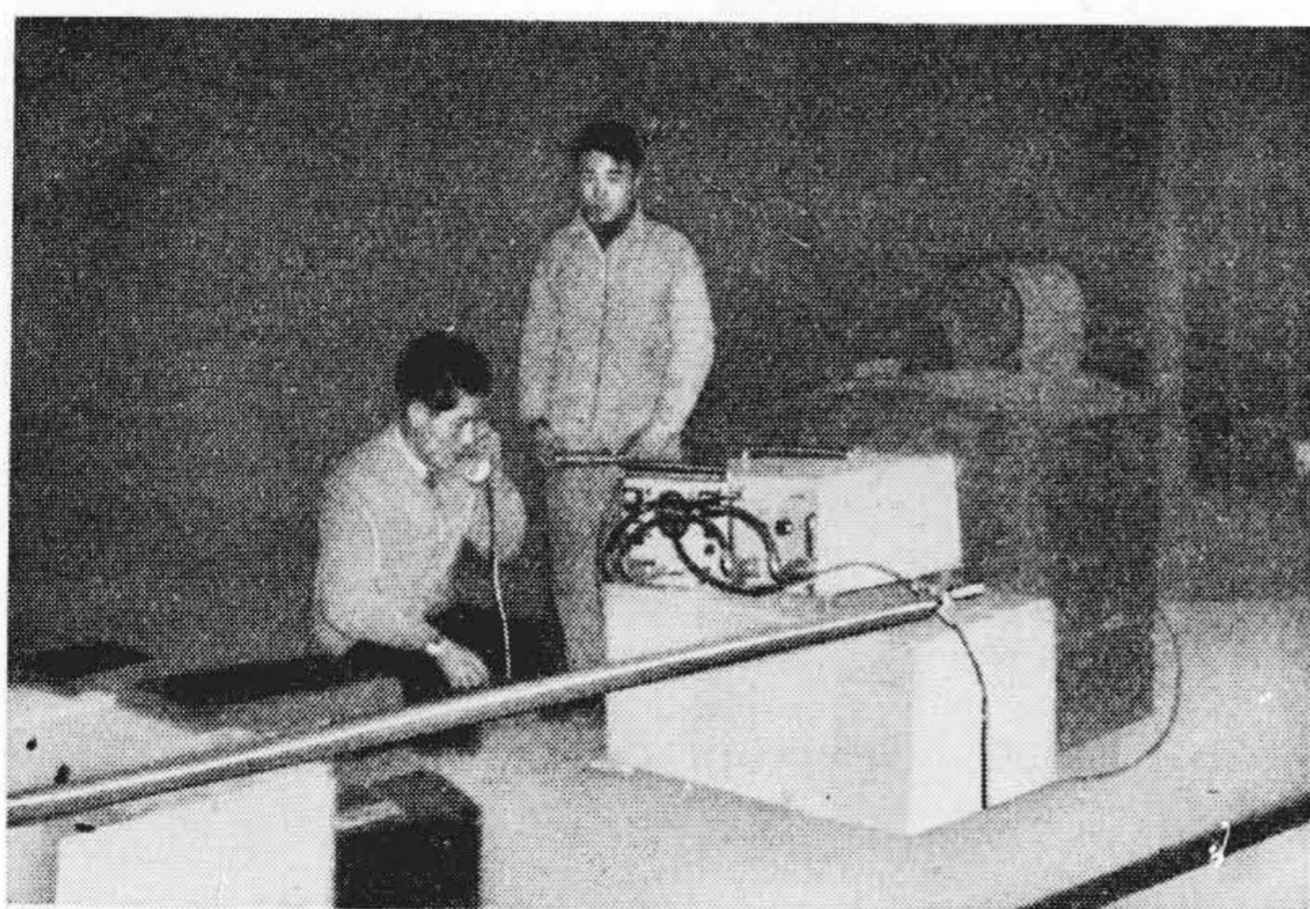
第9図 VHF用トランス使用状況 Fig.9. VHF Transformer in Service
