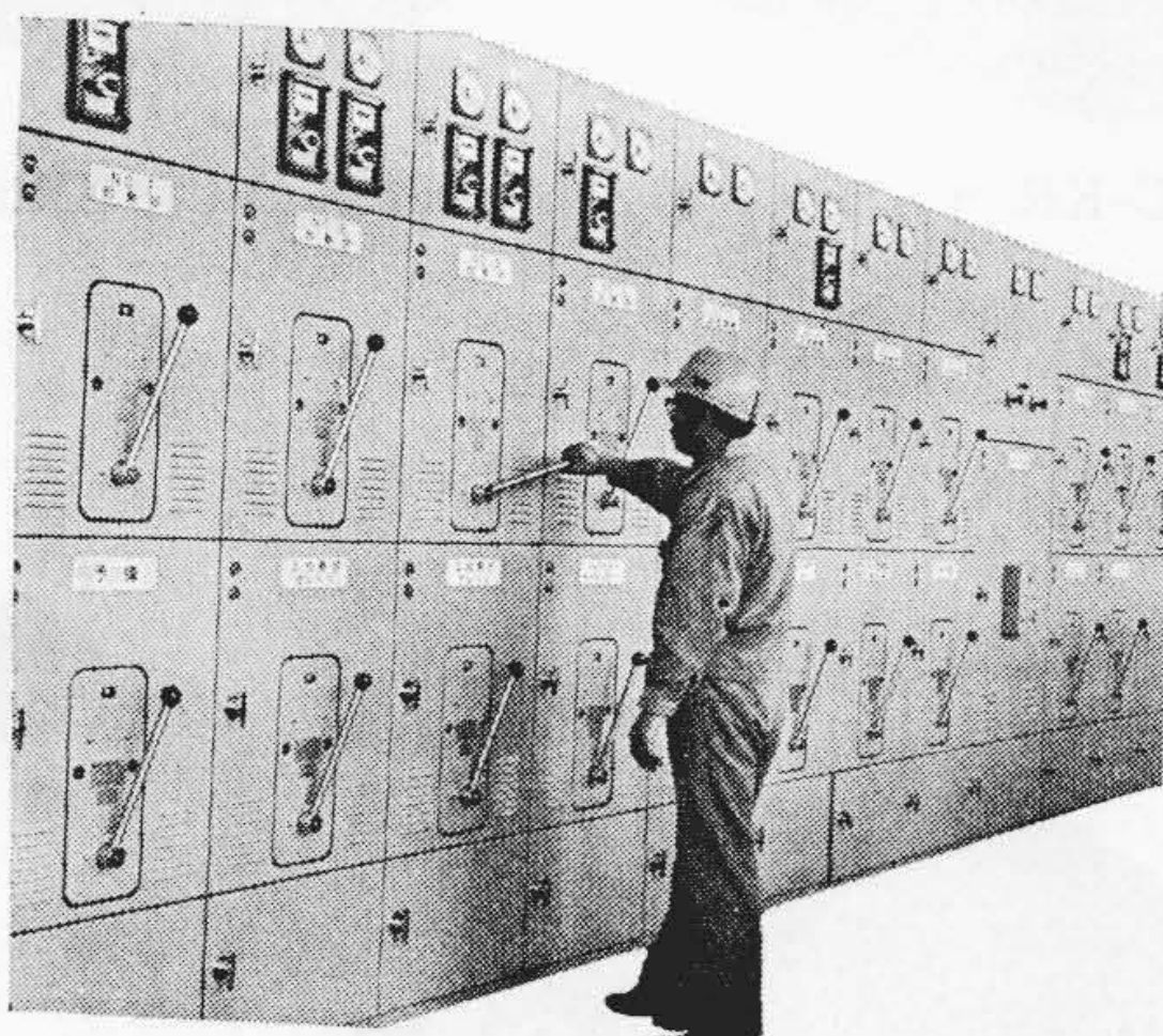
(気中遮断器を手動ハンドルにより投入しているところ)
