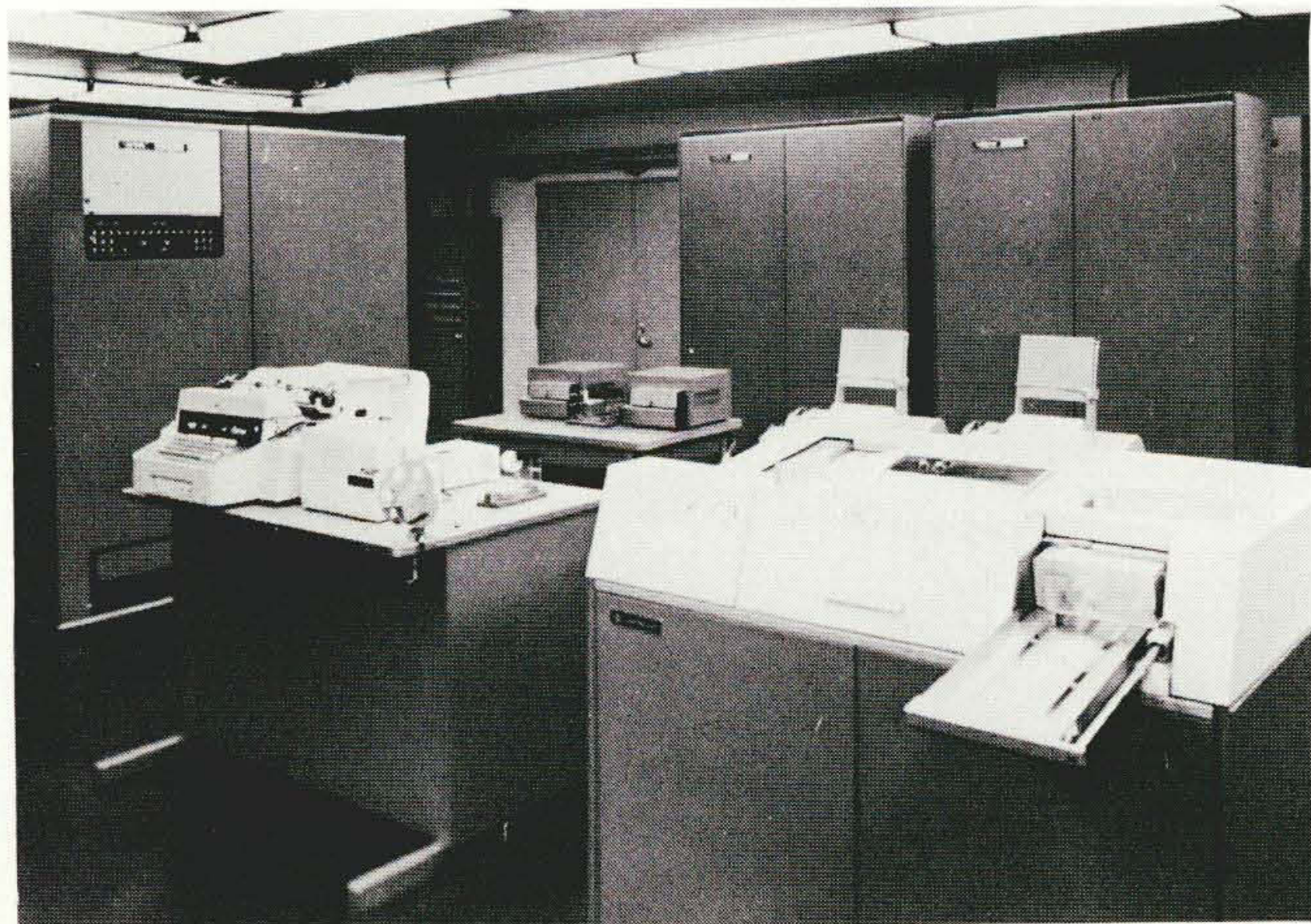
図3 中央給電指令室
