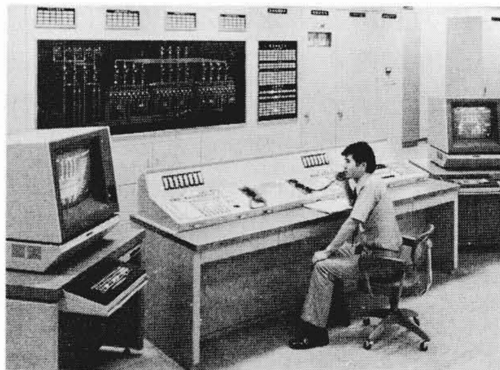
中央監視制御装置(受変電、空調衛生)
