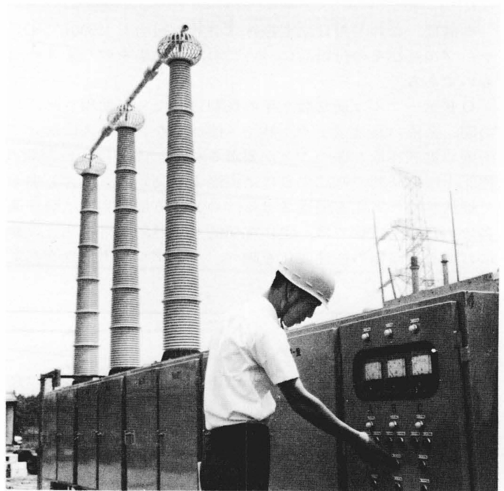
図2 500kV OFケーブルの課通電試験状況 ケーブルの導体温度は、電子計算機によって常時監視し、温度は通電電流の加減によって制御した。
