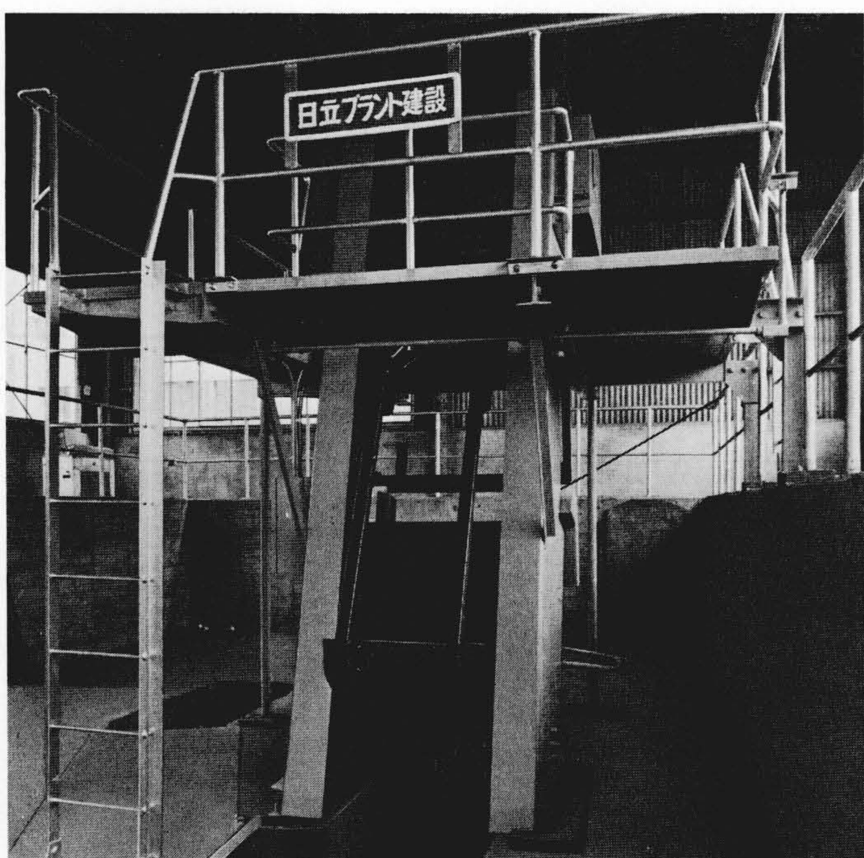
図 4 ハイチェーン式自動除塵機 東久留米市下谷下水処理場に設置されたものを示す。
