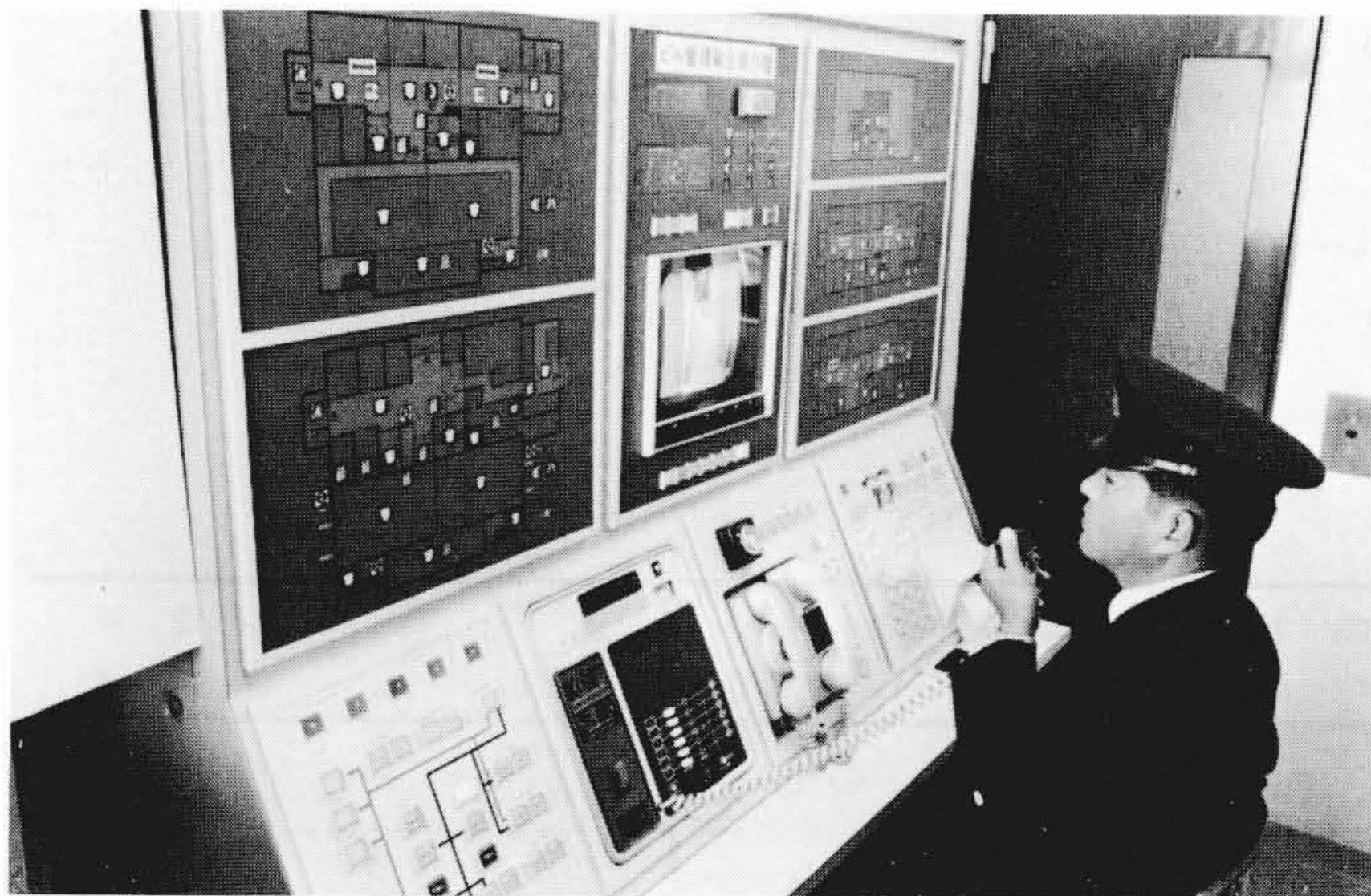
図3 総合操作盤("HIFICS 500") ビル管理機能を持った防災盤の外観を示す。
