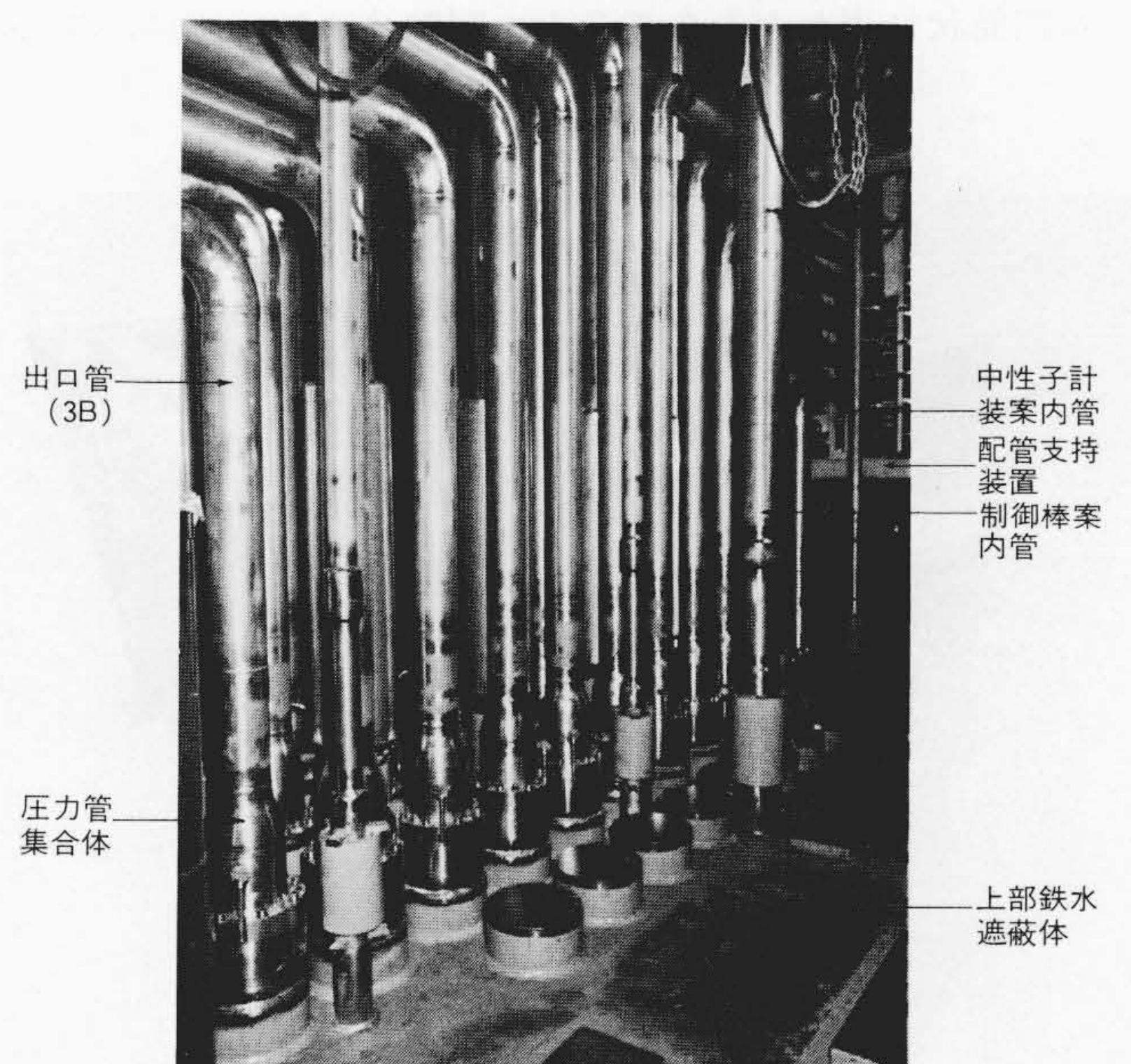
図4 出口管 原子炉本体上部の出口管を示すもので、圧力管集合体と接続されているところが見える。手前の蓋をしてあるノズルは、圧力管集合体が挿入されていないものを示す。
