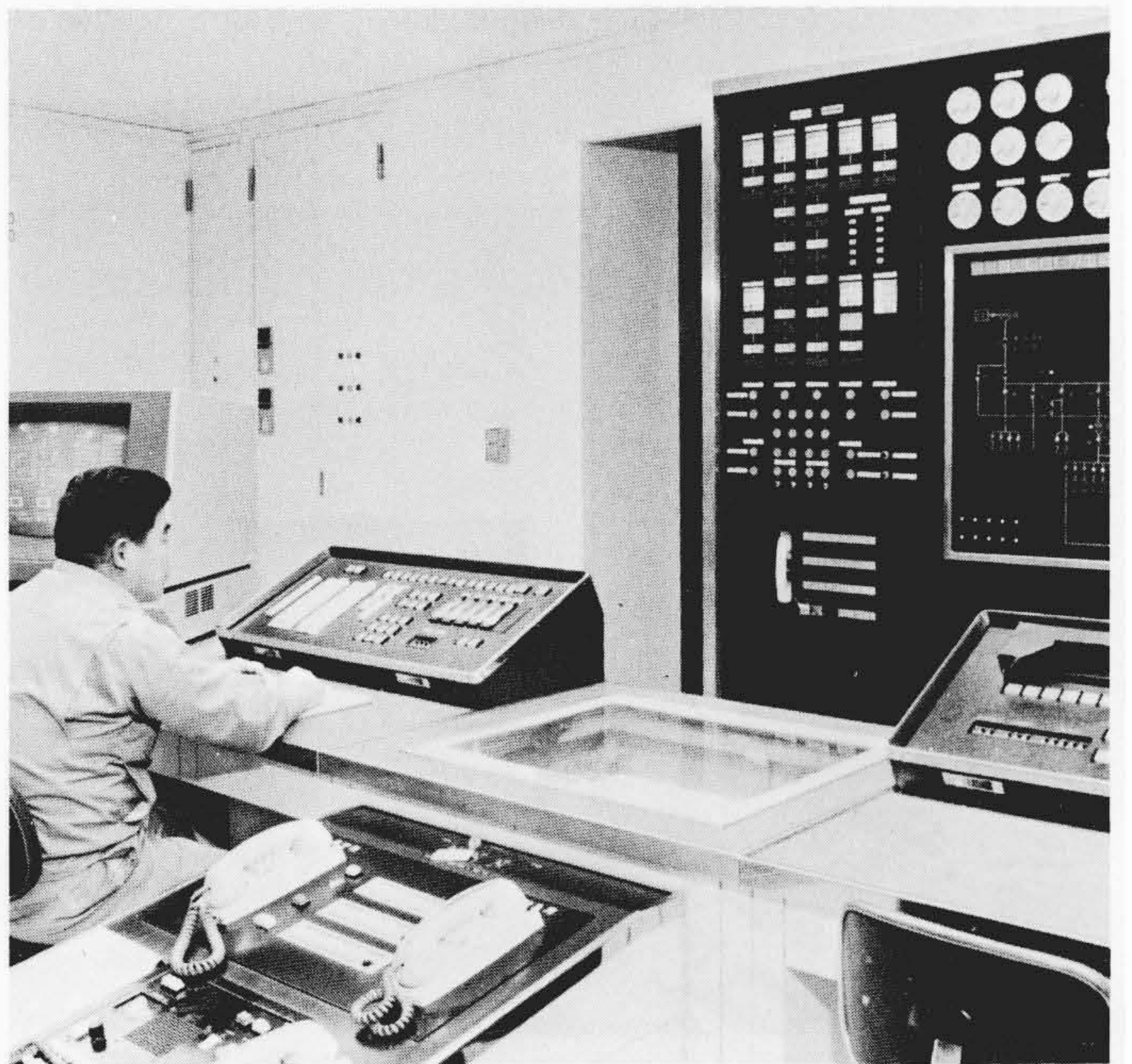
図6 データロギングによるエレベーター監視(株式会社三和銀行本店中央監視室) ビルコンとの連動で、エレベーター運行状況はデータロギングされ、エレベーターの自動監視が行なわれる。この方式は、ビルコンとエレベーターシステムの連動が比較的容易であり、実施例も多い。
