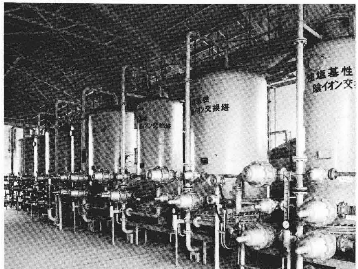
図7 廃水再利用装置
