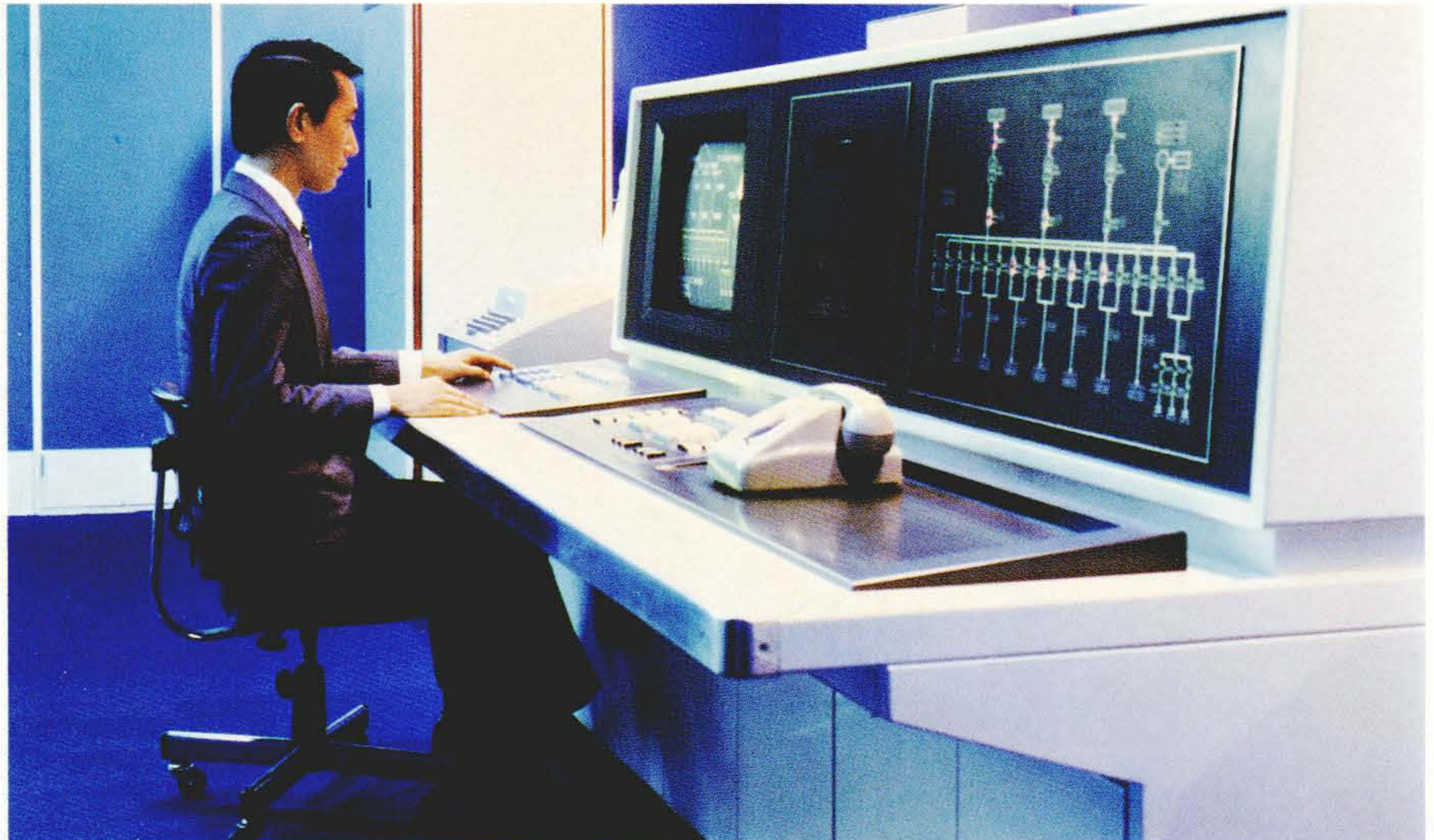
BUILMAX-08, 80監視操作デスク
