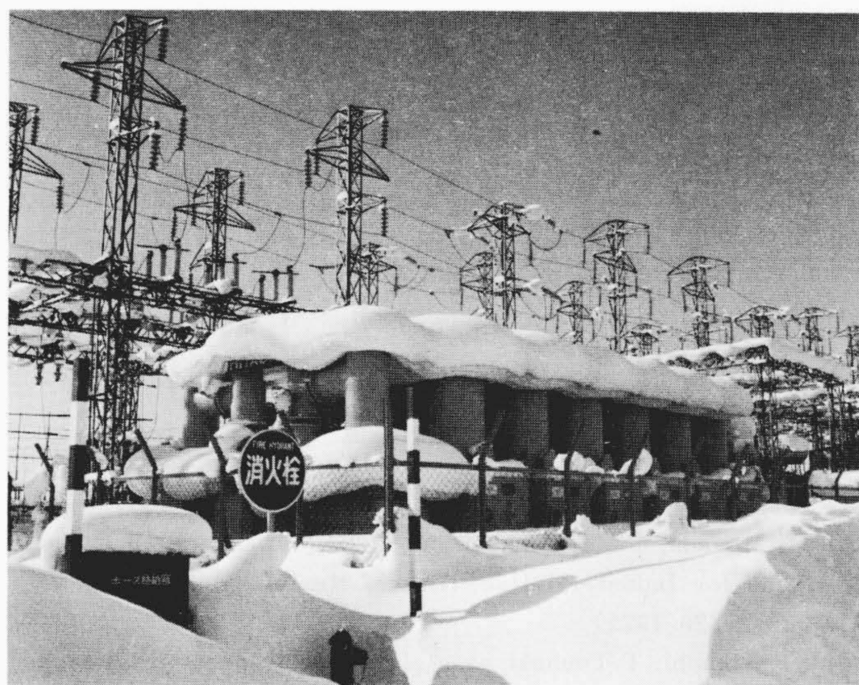
図12 77kV三相一括形ガス絶縁開閉装置 厳しい自然環境の中でも良好に運転されている。
