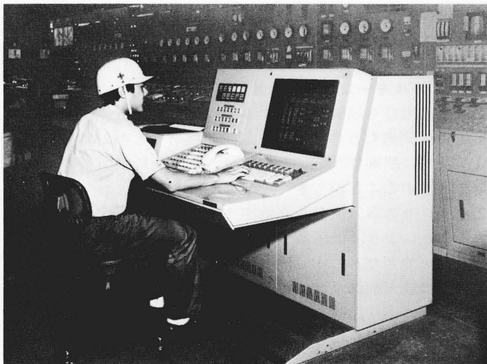
図6 オペレータコンソールデスク外観 プラントを監視・制御するためのオペレータコンソールデスクの外観を示す。
