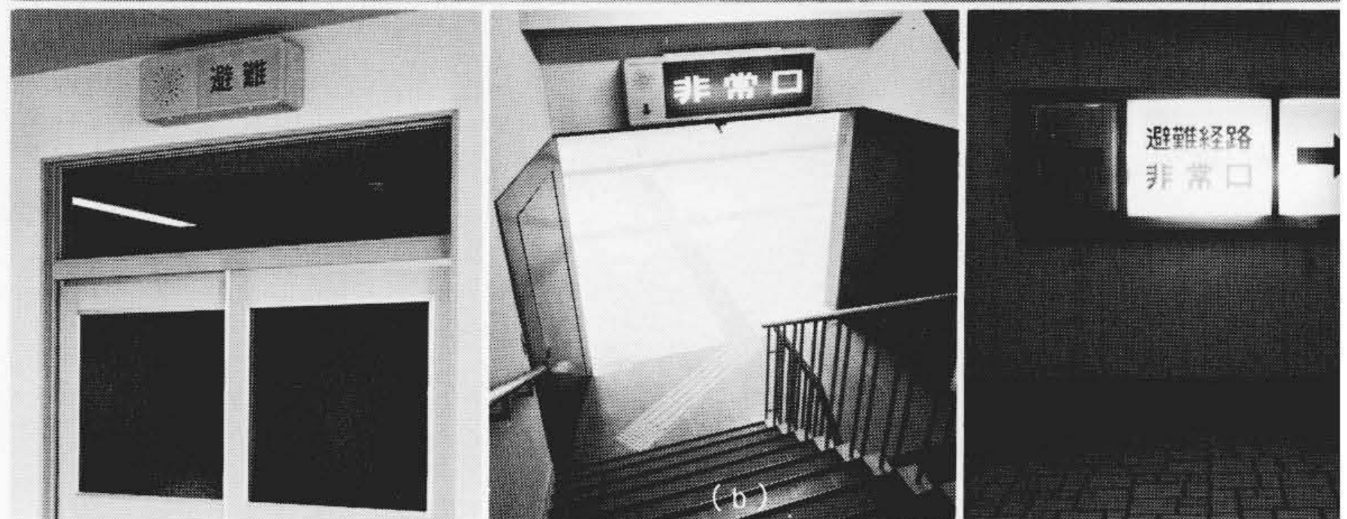
図8 (a) 避難誘導制御装置及び総合操作盤、(b) 室内警報灯、通路誘導表示及び避難口誘導表示器
