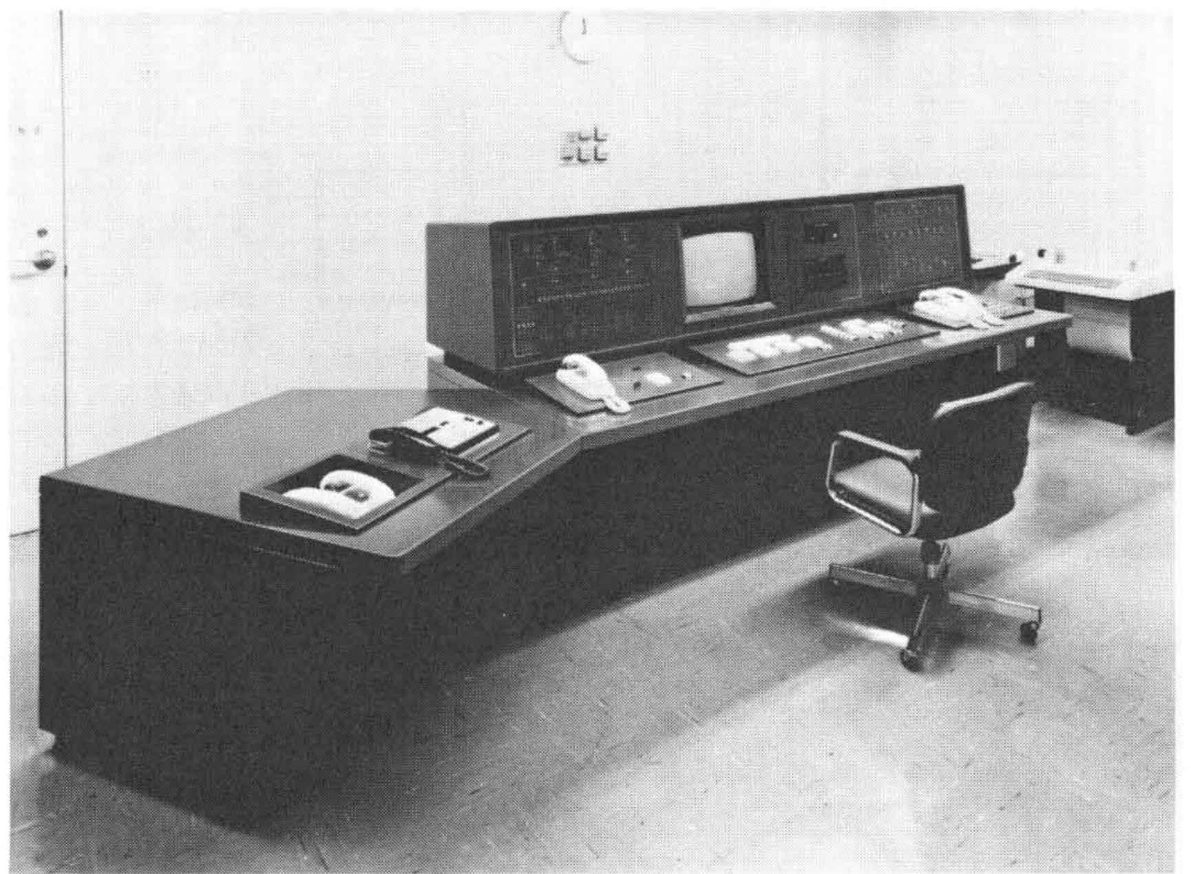
図1 中・大形ビル管理システムの中央監視装置 中・大形ビル管理システム用の中央監視装置の外観を示す。
