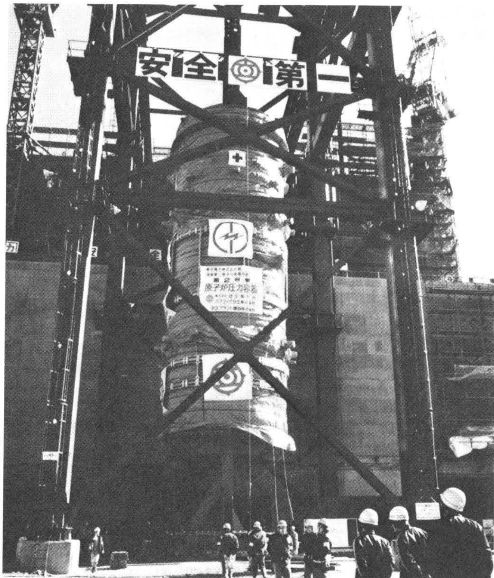
図2 電気出力1,100MW級RPV 世界初の遠隔自動超音波探傷装置用一体型構造軌道を仮設した、搬入前の原子炉圧力容器を示す。
