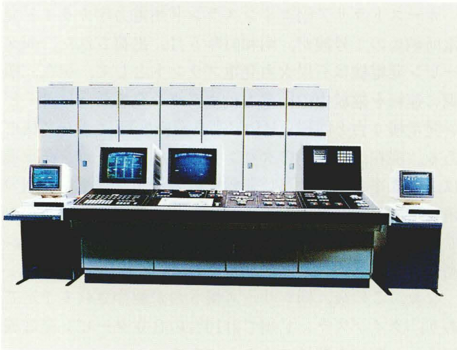
HIACS-3000システムのコンソールと制御装置 CRTオペレータコンソール(前列中央部)、中央集約形専用保守ツールであるエンジニアコンソール(前列両側)、及びボイラ、バーナ、補機、タービンを制御対象とした制御キャビネット群(後列)から成る。
