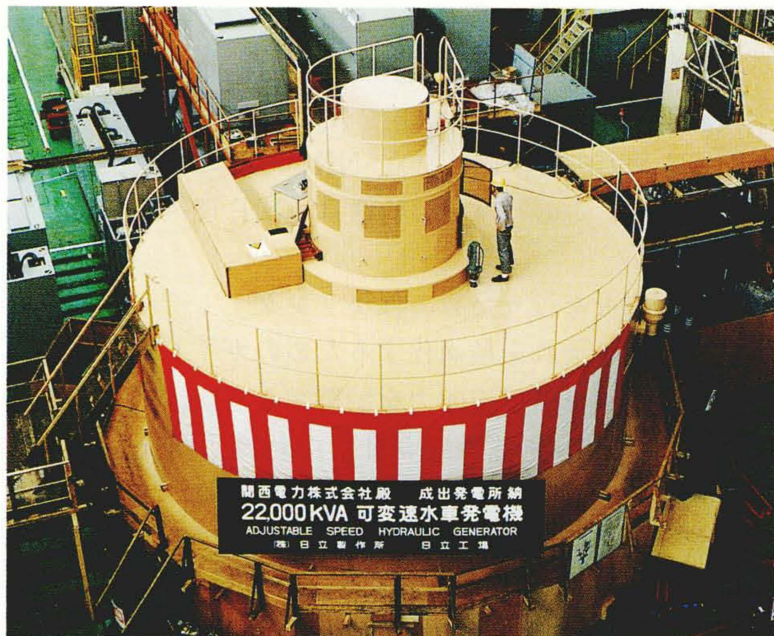
工場完成した可変速発電機 本発電機は、背後に見えるサイクロコンバータ及び制御装置などと組み合わせて試験を実施し、各種性能の確認を行った。
