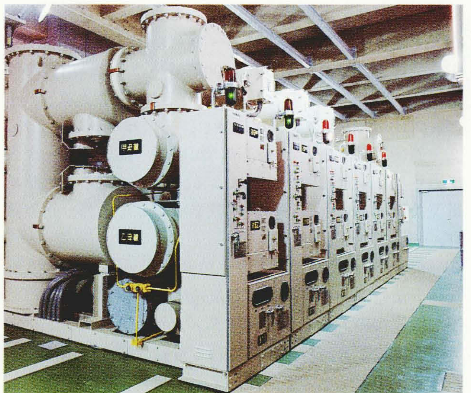
72kV超小形ガス絶縁開閉装置(二重母線方式)
