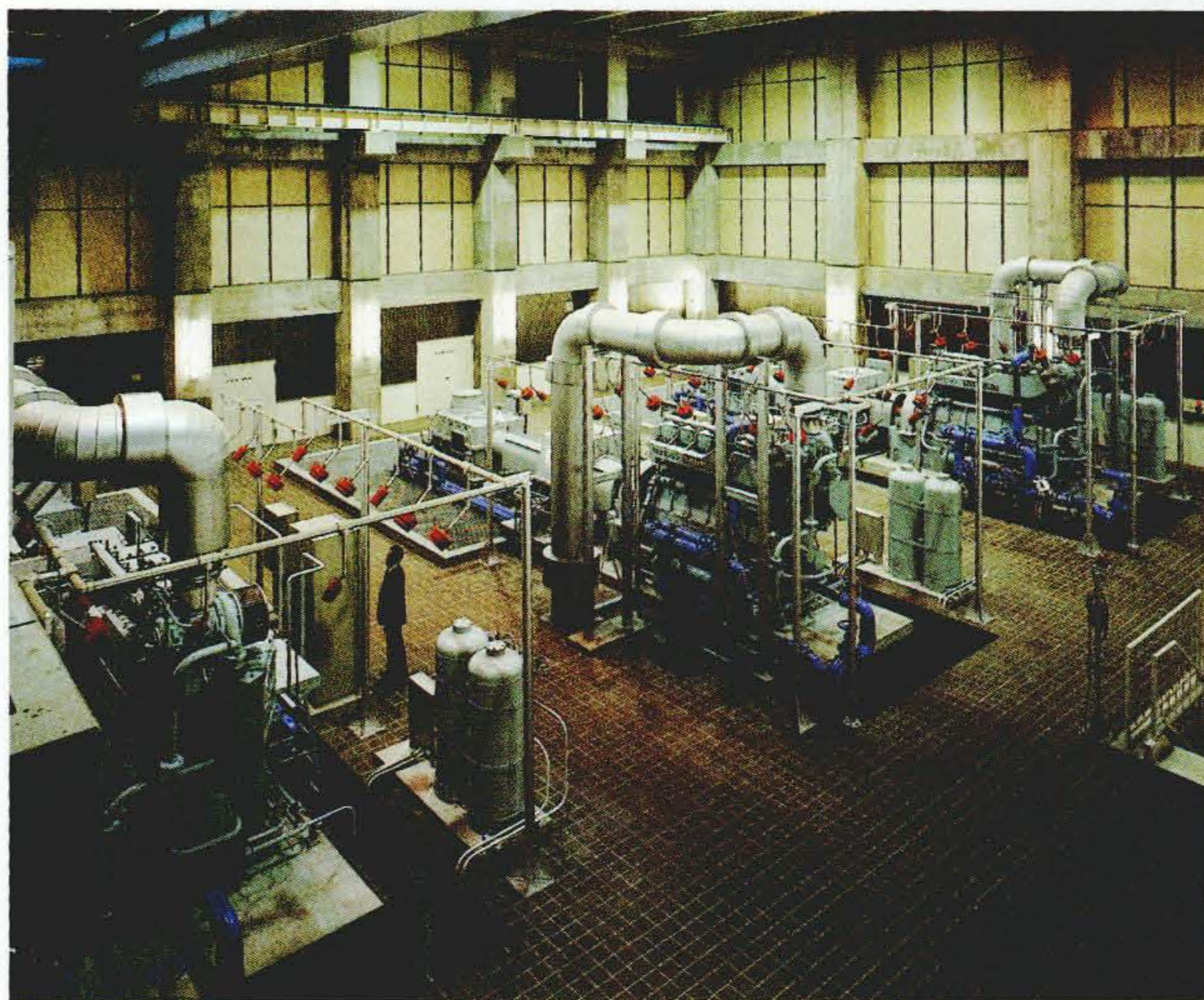
口径2,600mm主ポンプ設備
