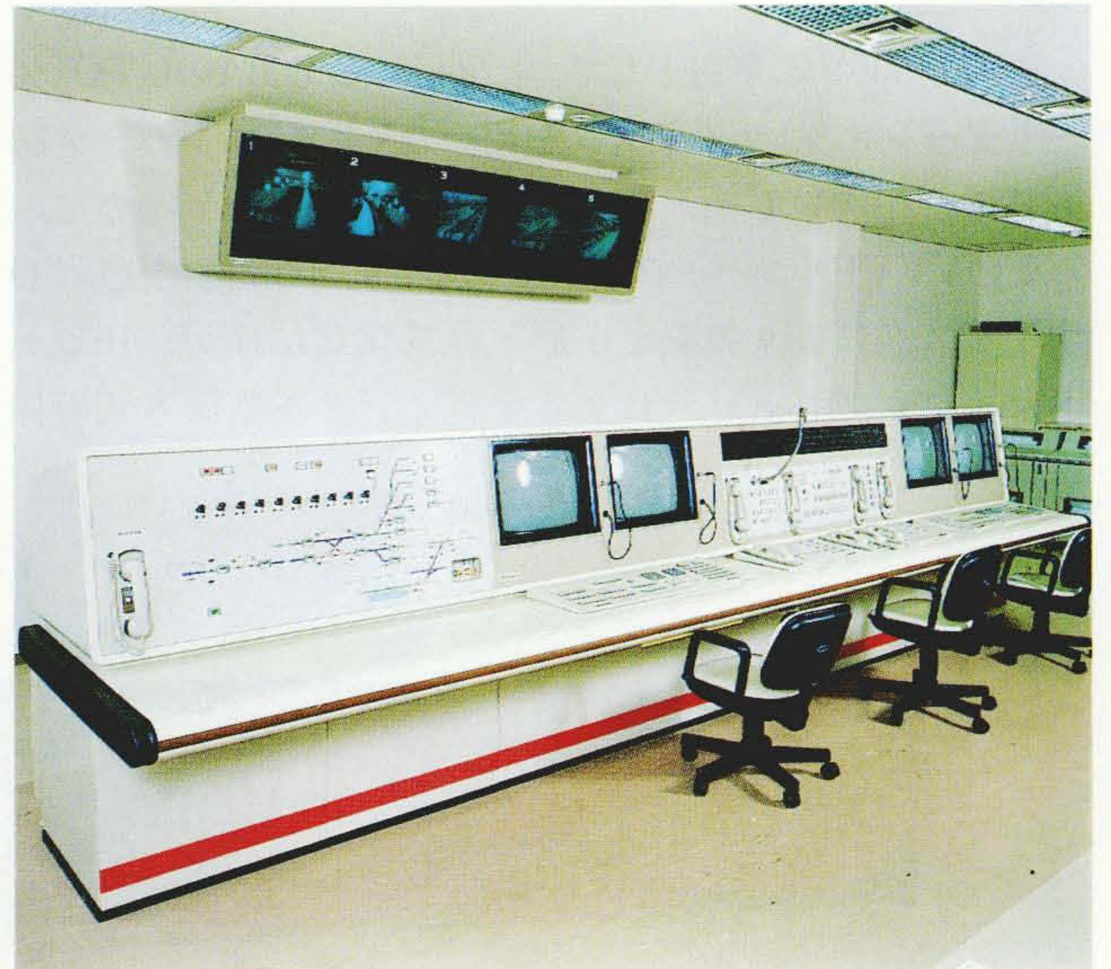
中央指令室 遠方監視用表示盤をなくし、ディスプレイの画面上で監視するシンプルな構成となっている。
