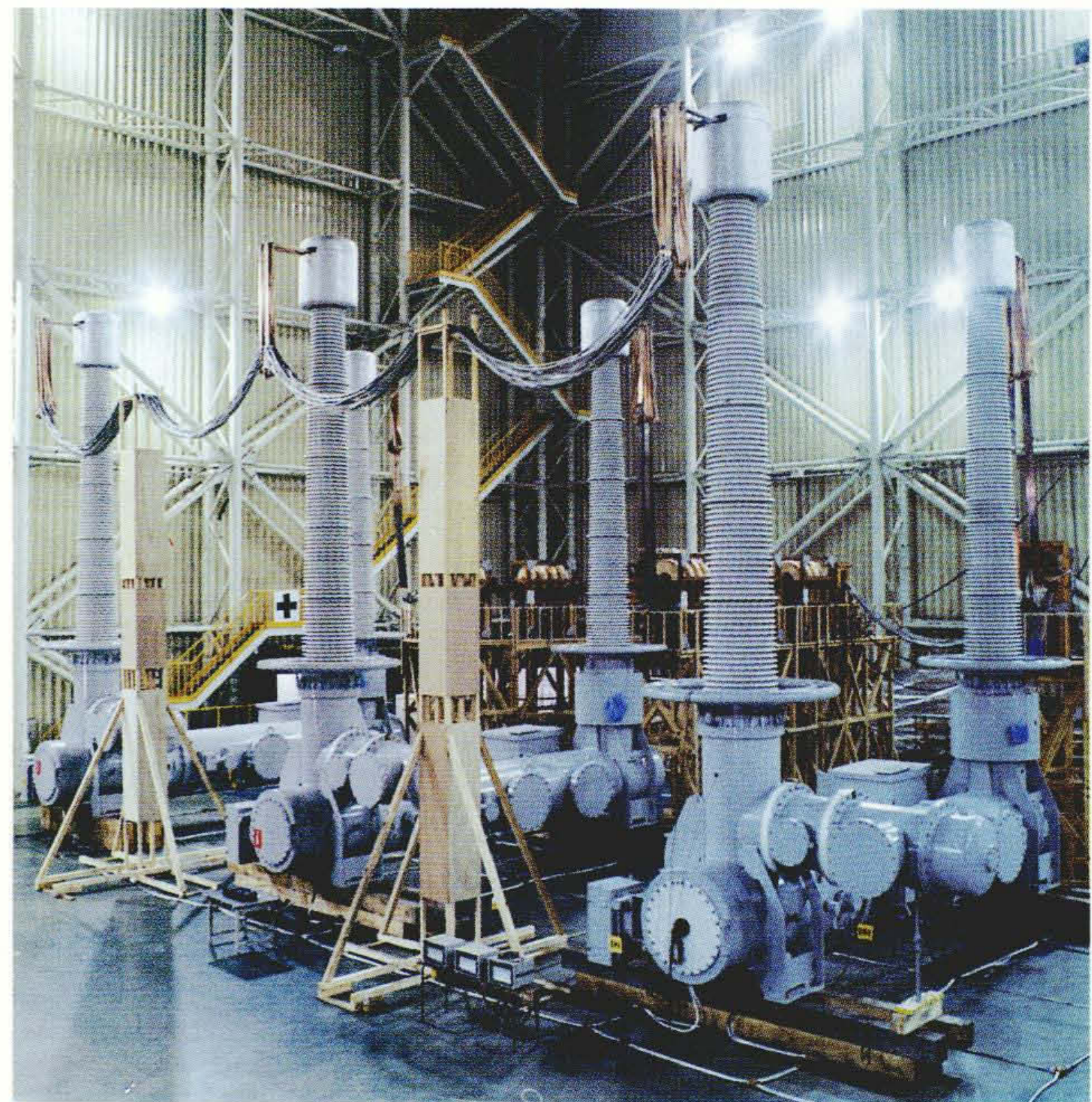
550 kV，8 kAガス複合開閉装置(三相通電試験中の実景)
