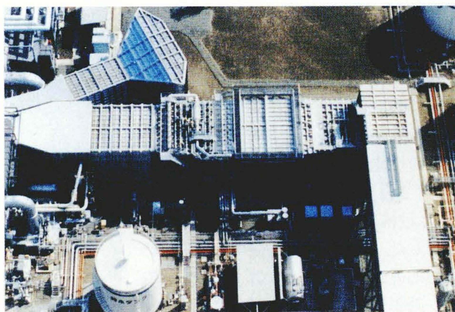
脱硝装置の外観(高効率ガスタービン技術研究組合提供)
