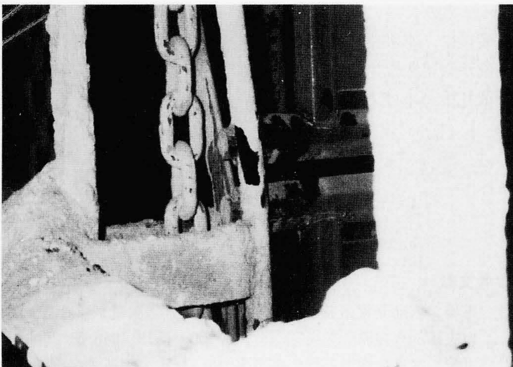
図8 リンクチェーンの設置状況 石炭ダストの中で移動するため、リンクとリンクの接点部が摩耗する。
