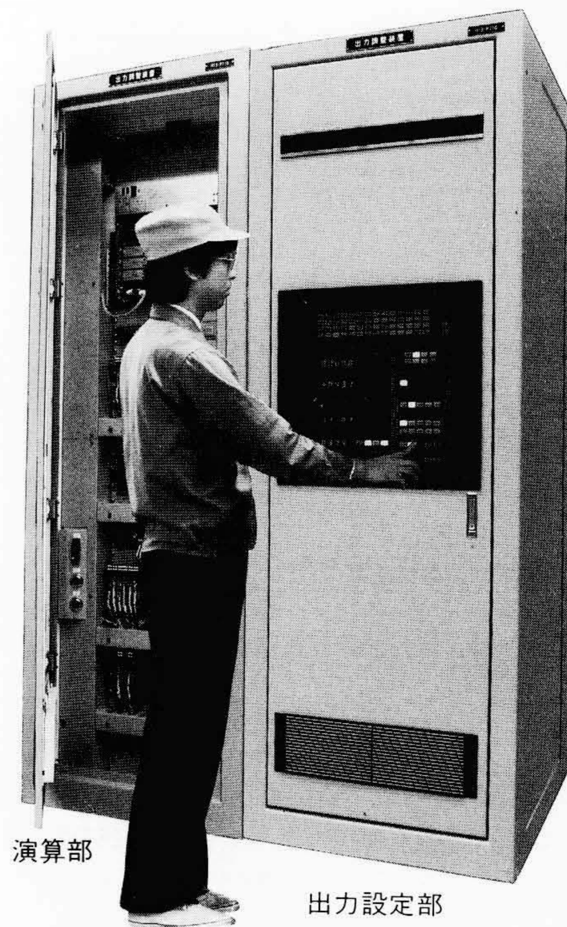
図11 自動出力設定装置 原子炉の出力設定を本装置から行うことにより、運転の簡素化が達成できた。保守性を上げるために、出力設定部と演算部を分割している。
