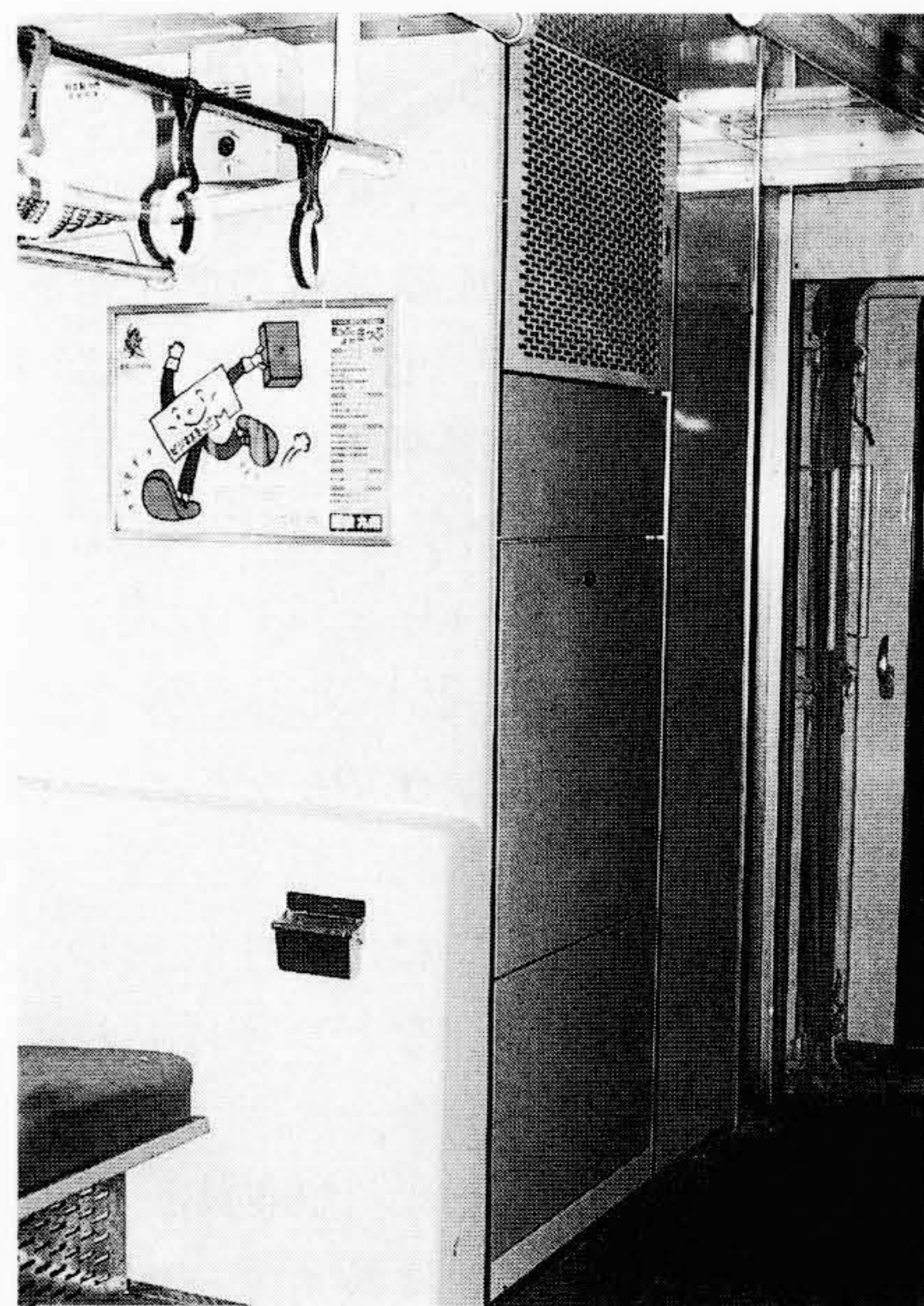
図10 床置形空調装置の適用例 床置形空調装置を、冷房化改造によって既存車両に適用した例を示す。
