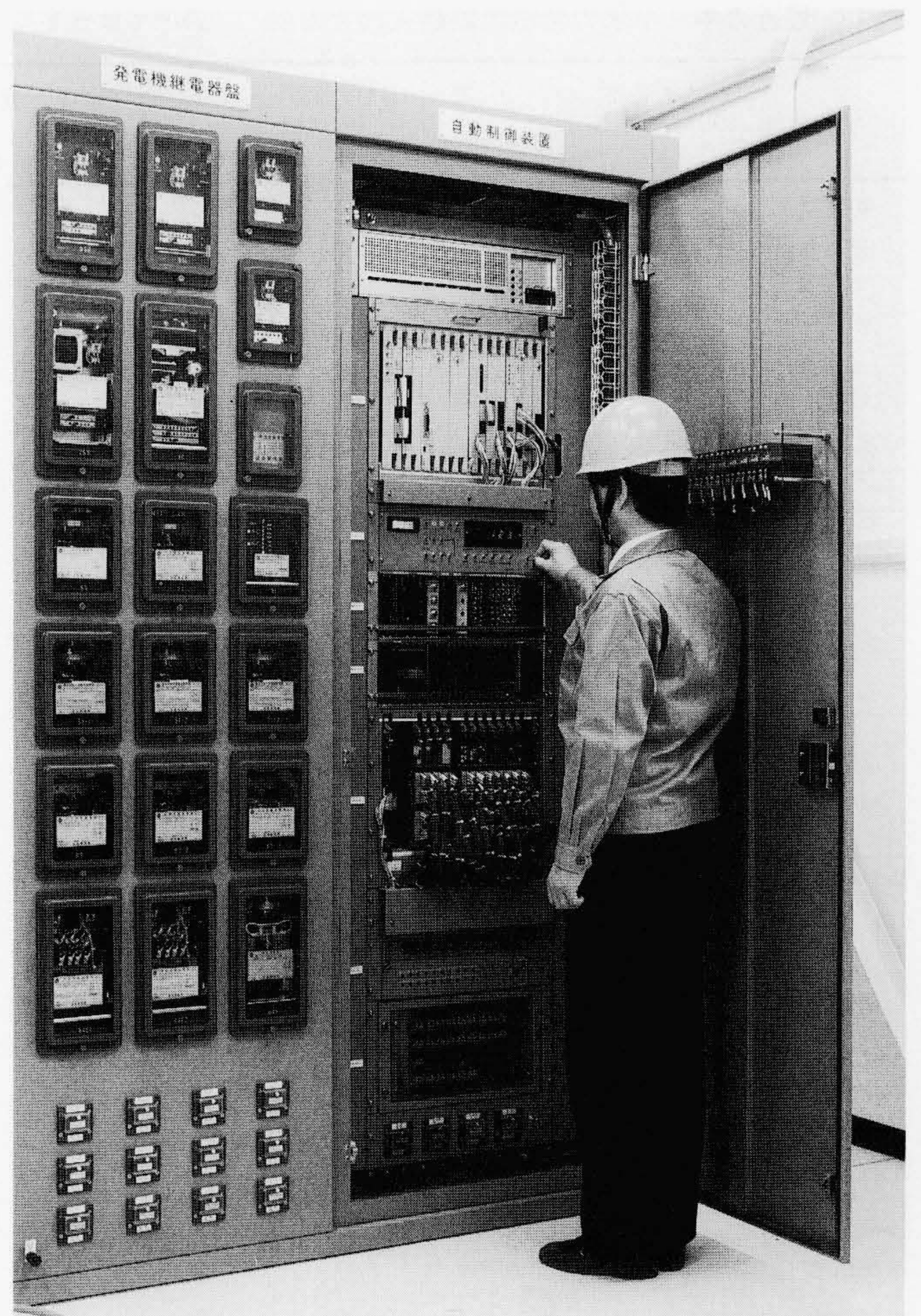
図10 機能集約形制御装置 運転制御、自動同期、励磁制御、調速機制御などの制御機能を一つのキュービクルで実現した装置正面写真を示す。
