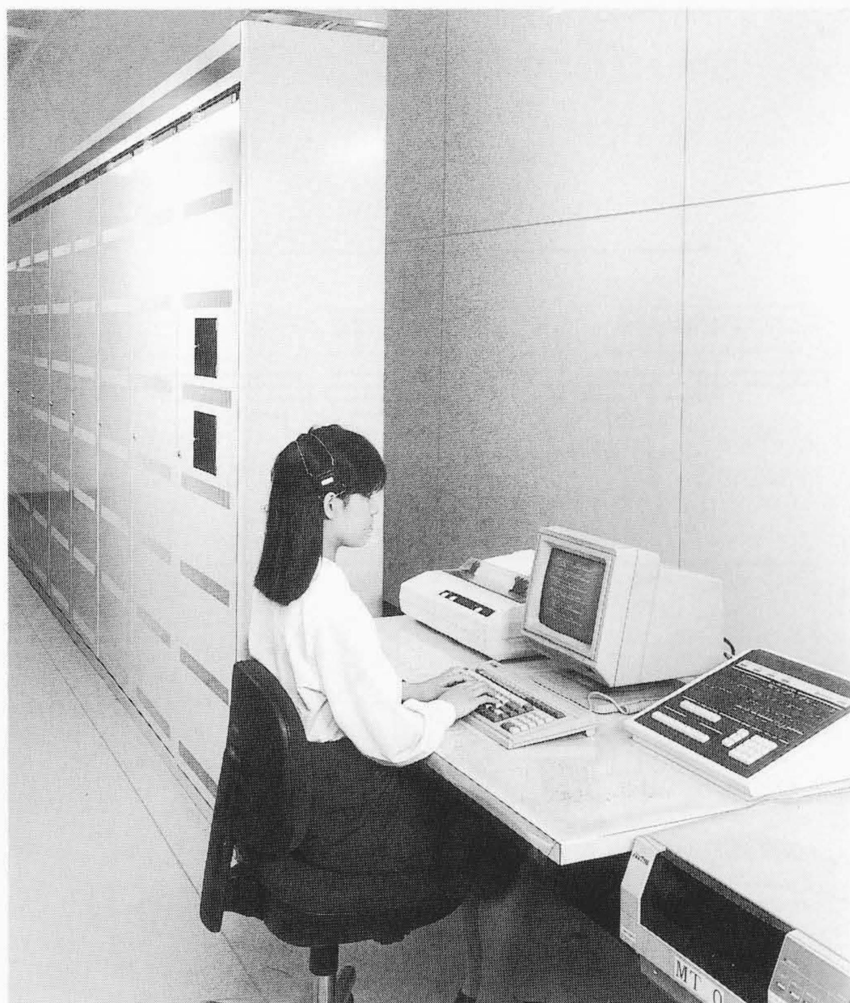
図1 業務公衆系交換機 この図は、東京統制局設置の業務公衆系交換機である。
