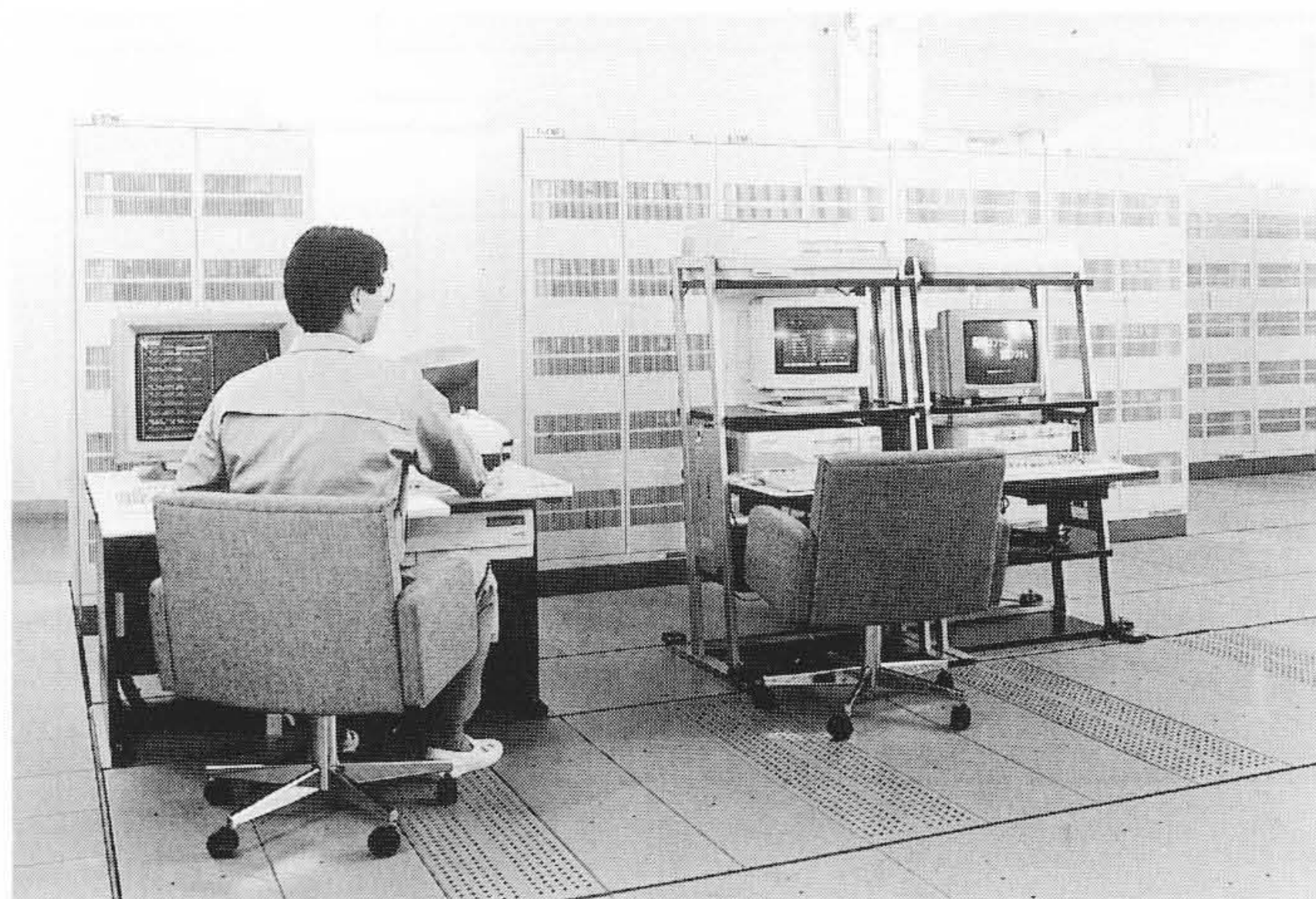
図6 ISDN加入者系交換機 右側がISM(4キャビネット)、前列左端がSTM(1キャビネット)である。STM手前のワークステーションから保守者が命令を投入し、保守運用中である。
