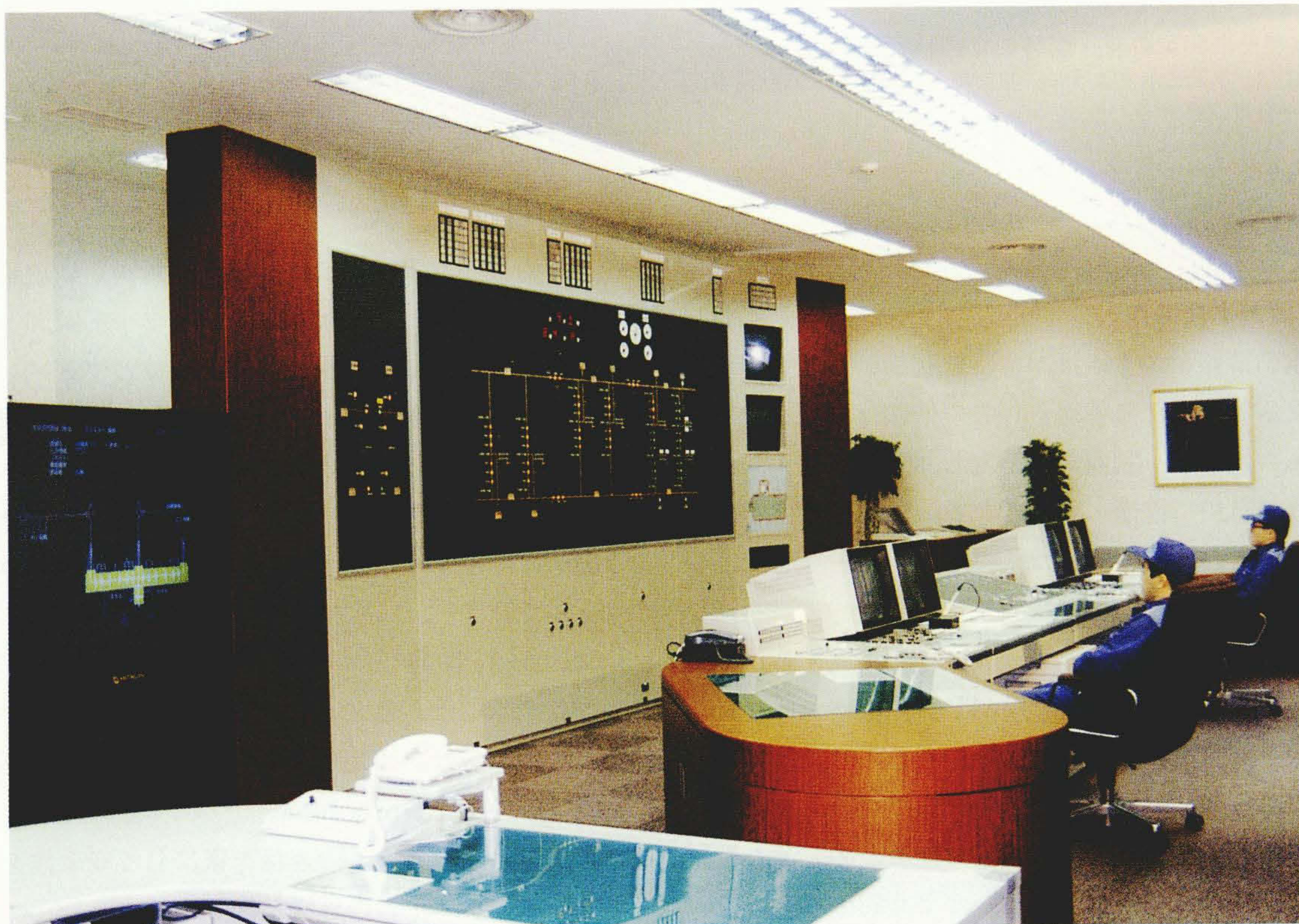
関西電力株式会社 東近江開閉所の制御室 系統のマクロ監視を系統盤で、ミクロ監視および機器操作はCRT制御卓から行う。
