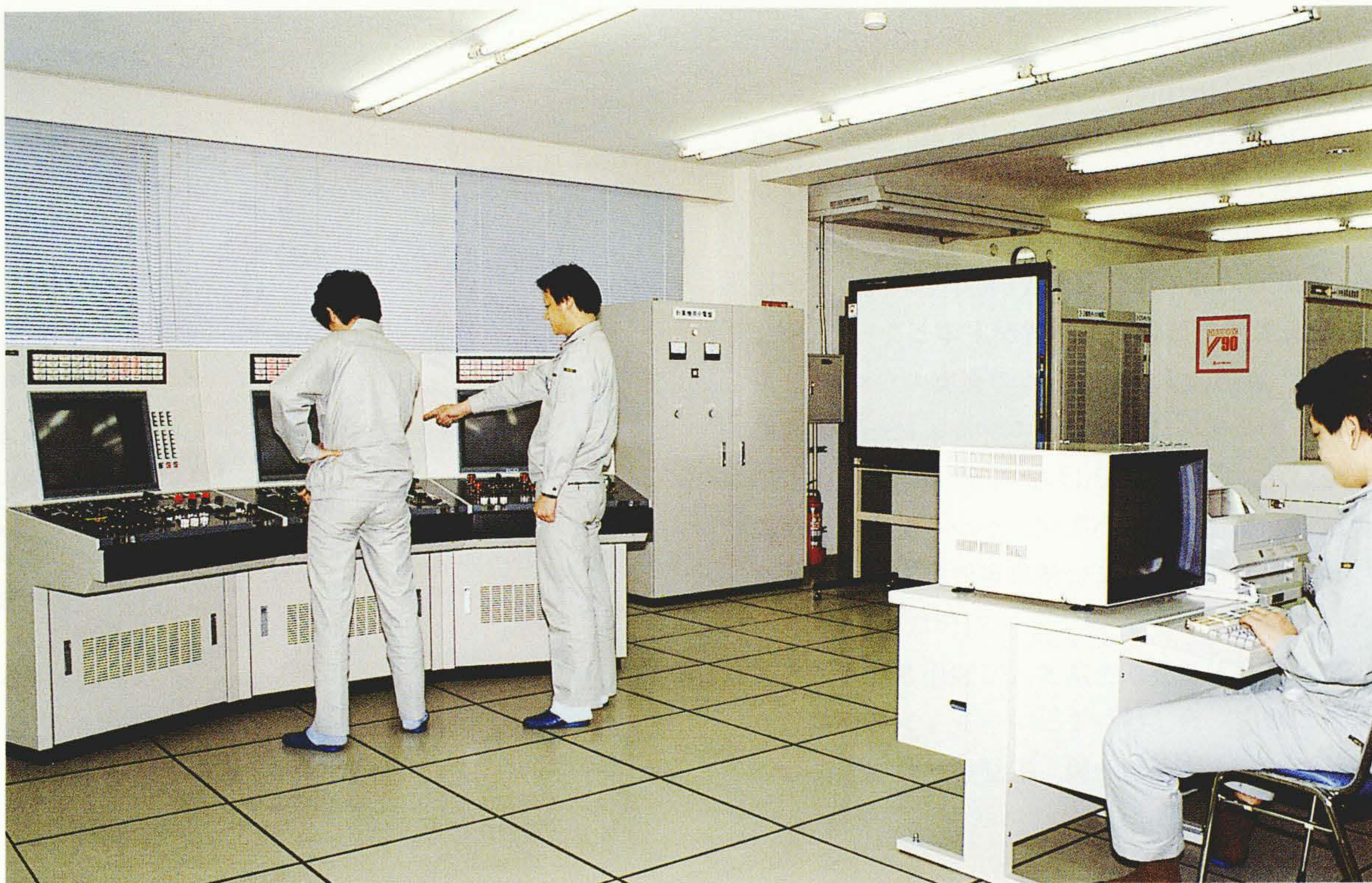
ATR運転高度化支援装置 運転訓練，プラント特性の学習，制御特性改善など多目的に使用可能な小型シミュレータである。
