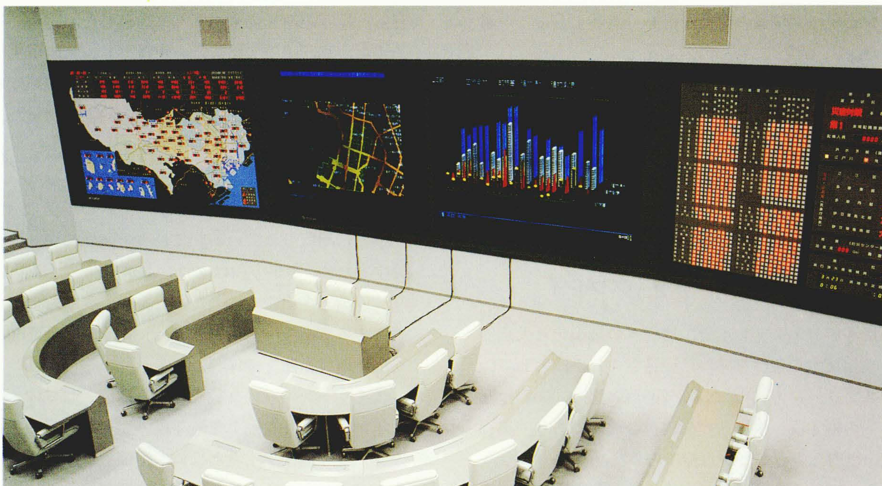
200形マルチスクリーンディスプレイ(中央2面) 東京都防災センター災害対策本部室に設置されたもので、ヘリコプターテレビジョン、コンピュータ映像など多彩な映像情報表示が可能である。両端の2面はLED(発光ダイオード)を使用した情報表示盤である(他社製)。
