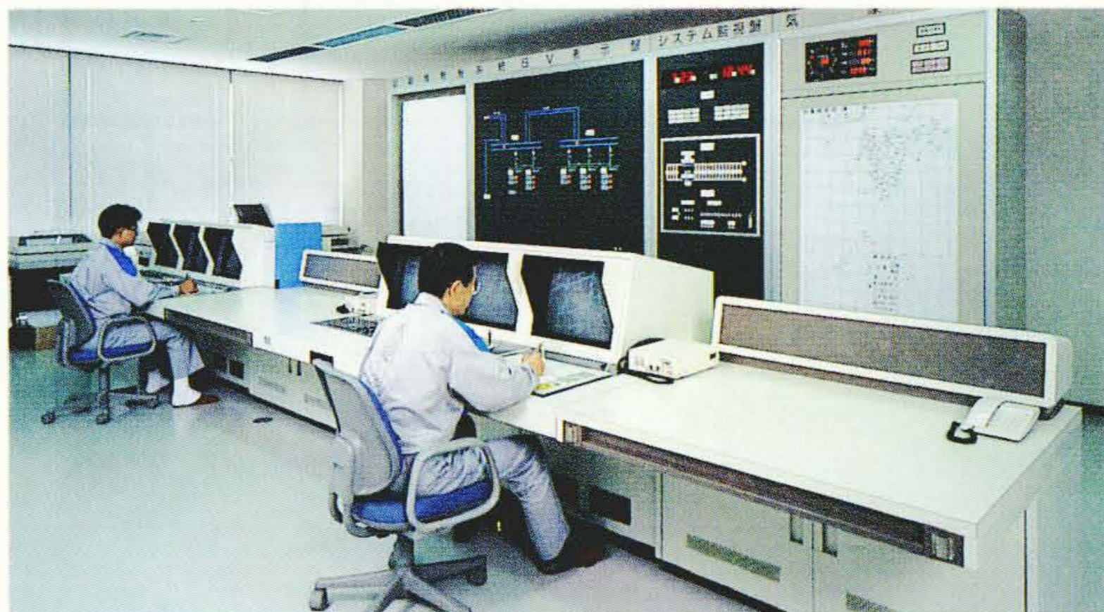
配電自動化システム操作卓(指令室)
