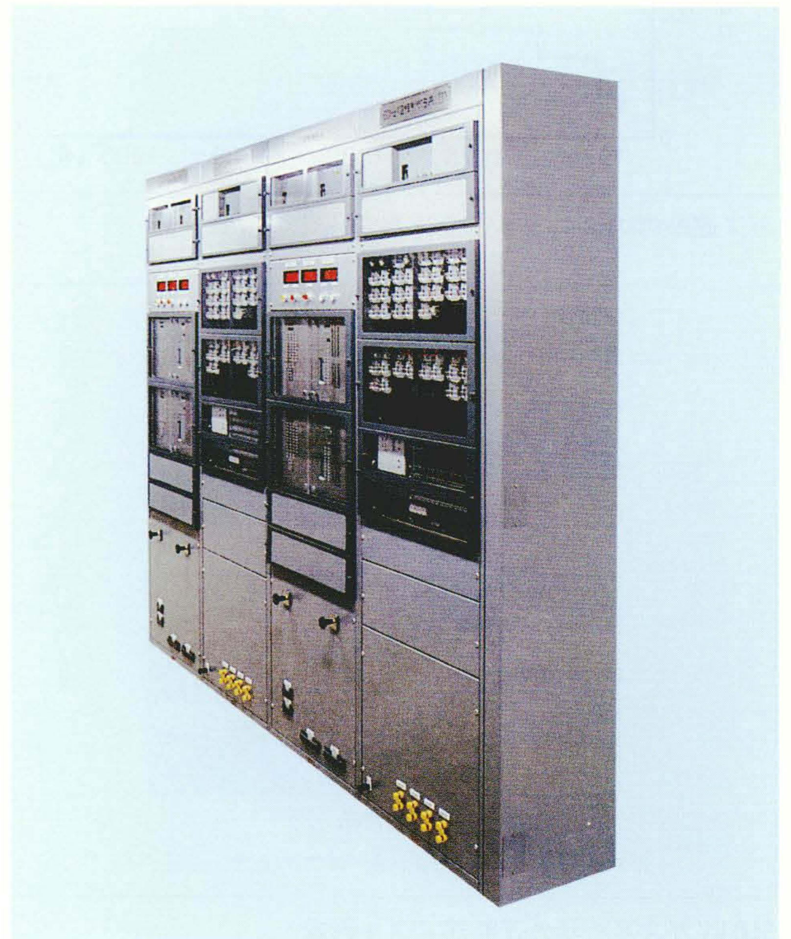
東京電力株式会社納め12相制御装置(二重化)
