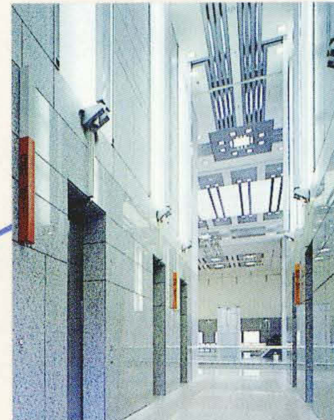
●超高速 エレベーター
