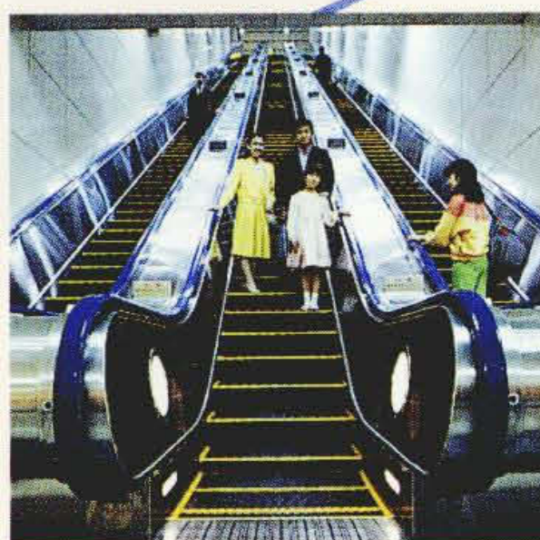
●高揚程エスカレーター
