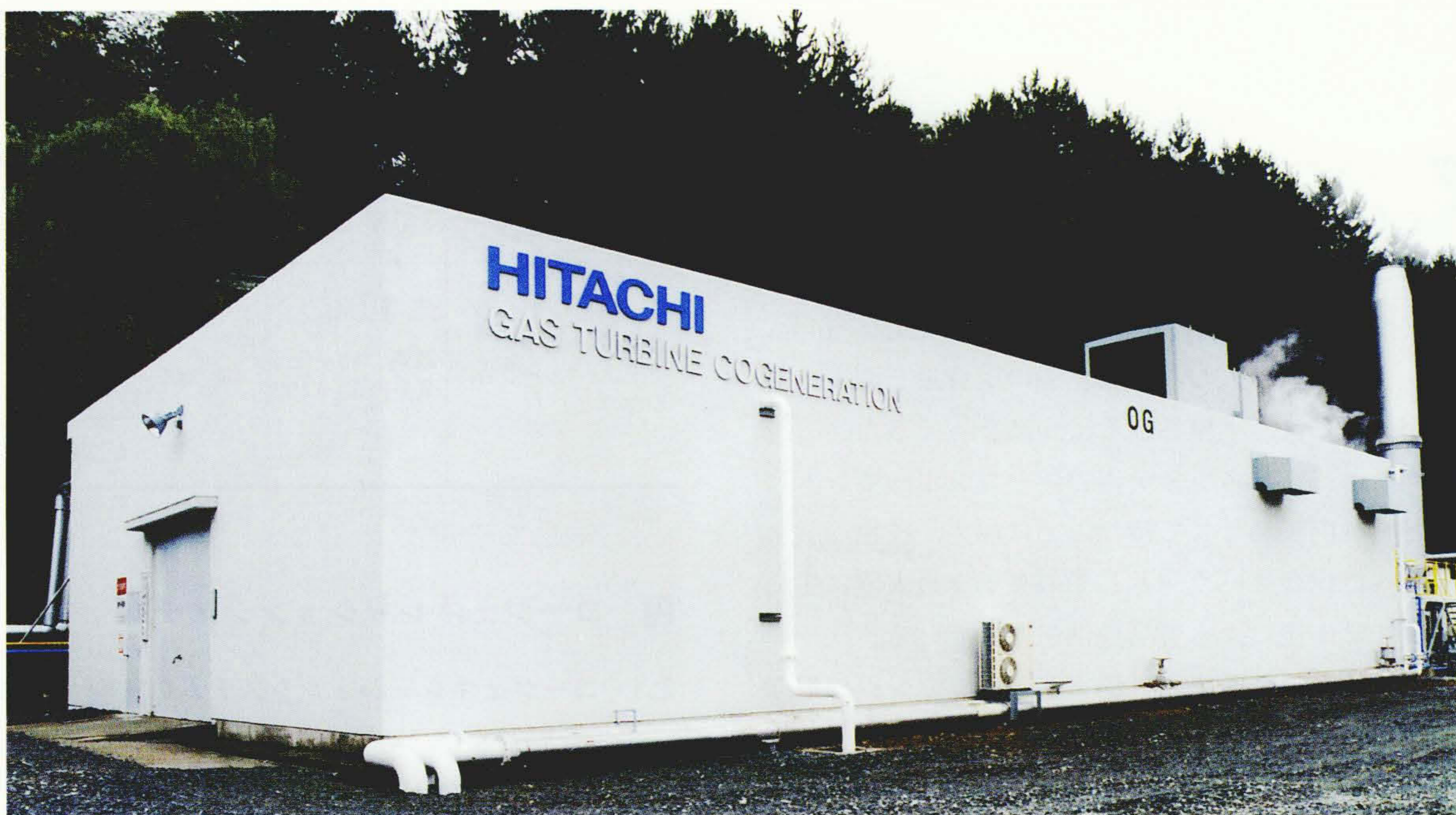
平成4年10月に日立製作所日立工場に設置したガスタービン コージェネレーション センタ 4.0 MW級ガスタービン設備を中心としたコージェネレーションシステムである。工場やビル、大学、病院などのエネルギーセンターとして、自家発電と排熱利用によって給湯、冷暖房などを同時に実現し、省エネルギー化を図る。
