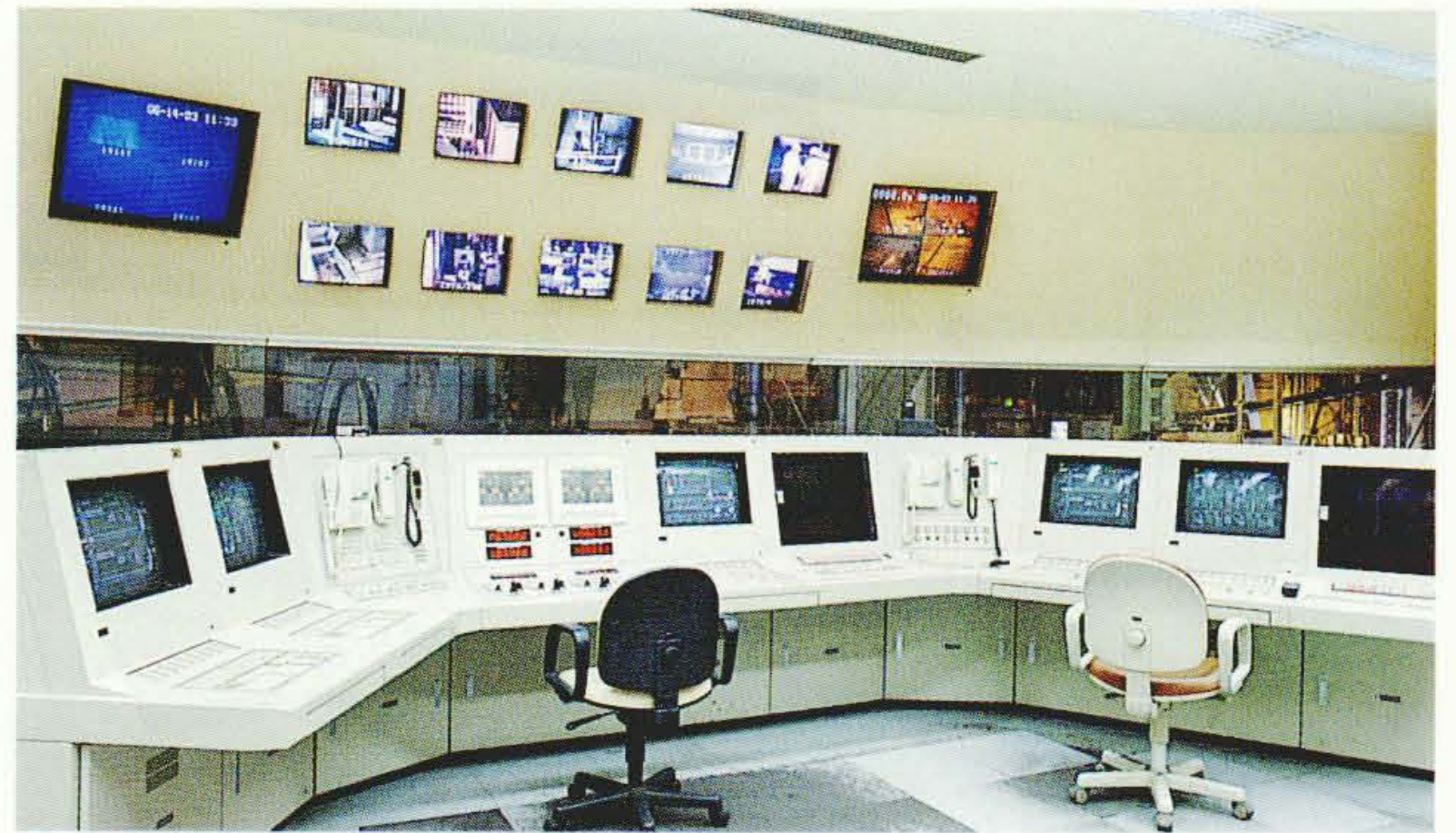
図3 監視HMI 中央操作室に設置されている操作・監視HMI(POCS)を示す。
