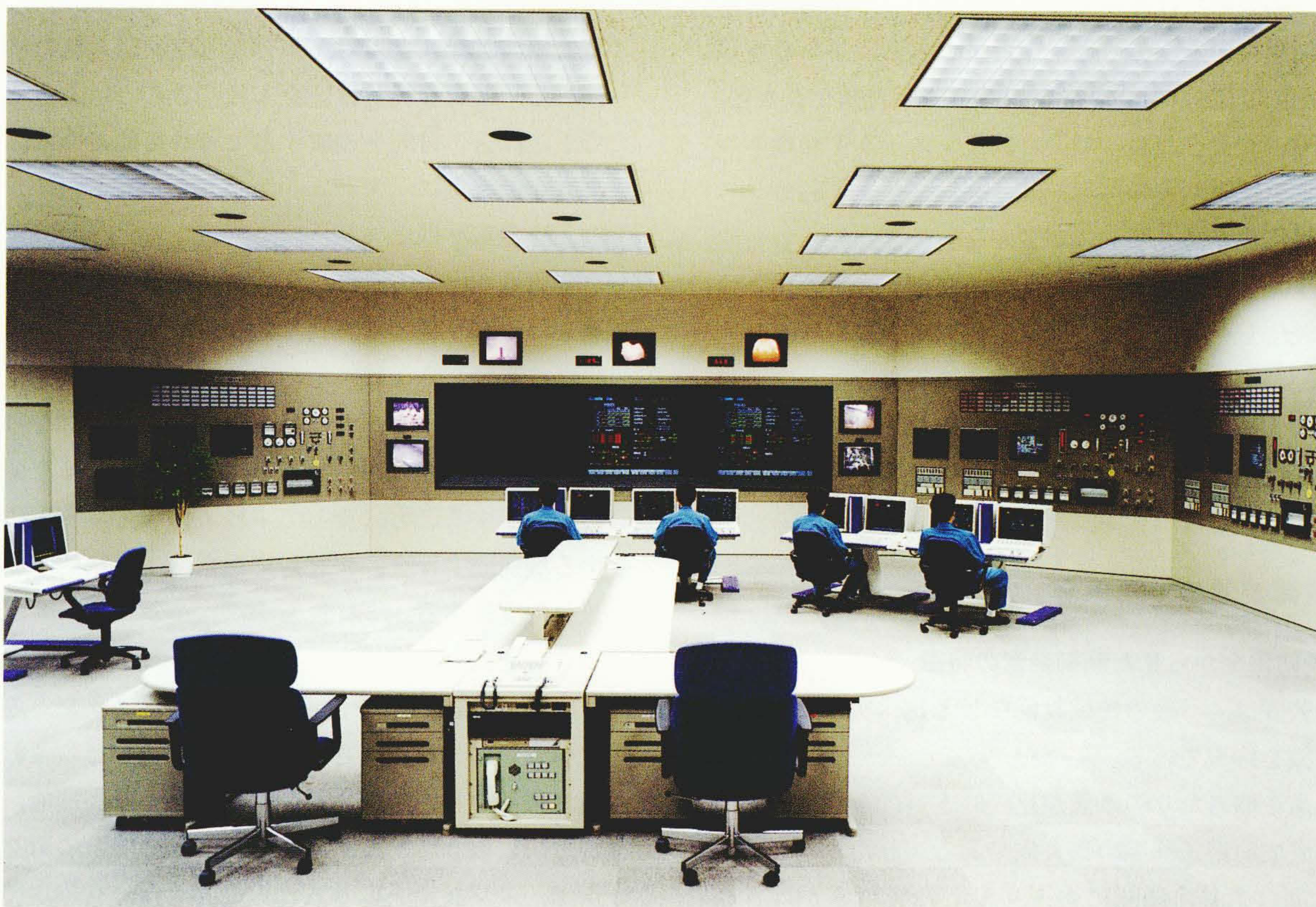
中国電力株式会社水島発電所の中央制御室 経年火力の制御設備近代化工事を実施し、中央制御室の集中化、プラントの全自動運転と操作監視および信頼性・運用性の向上を図っている。
