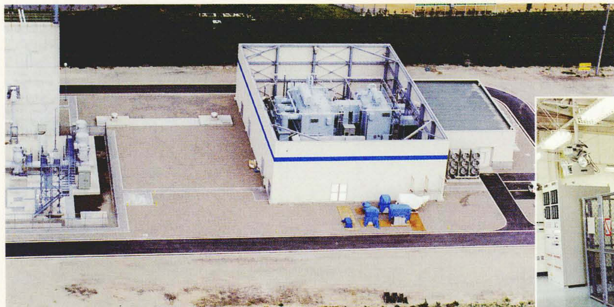
(a) 東北電力株式会社能代火力発電所SVCシステム全景
