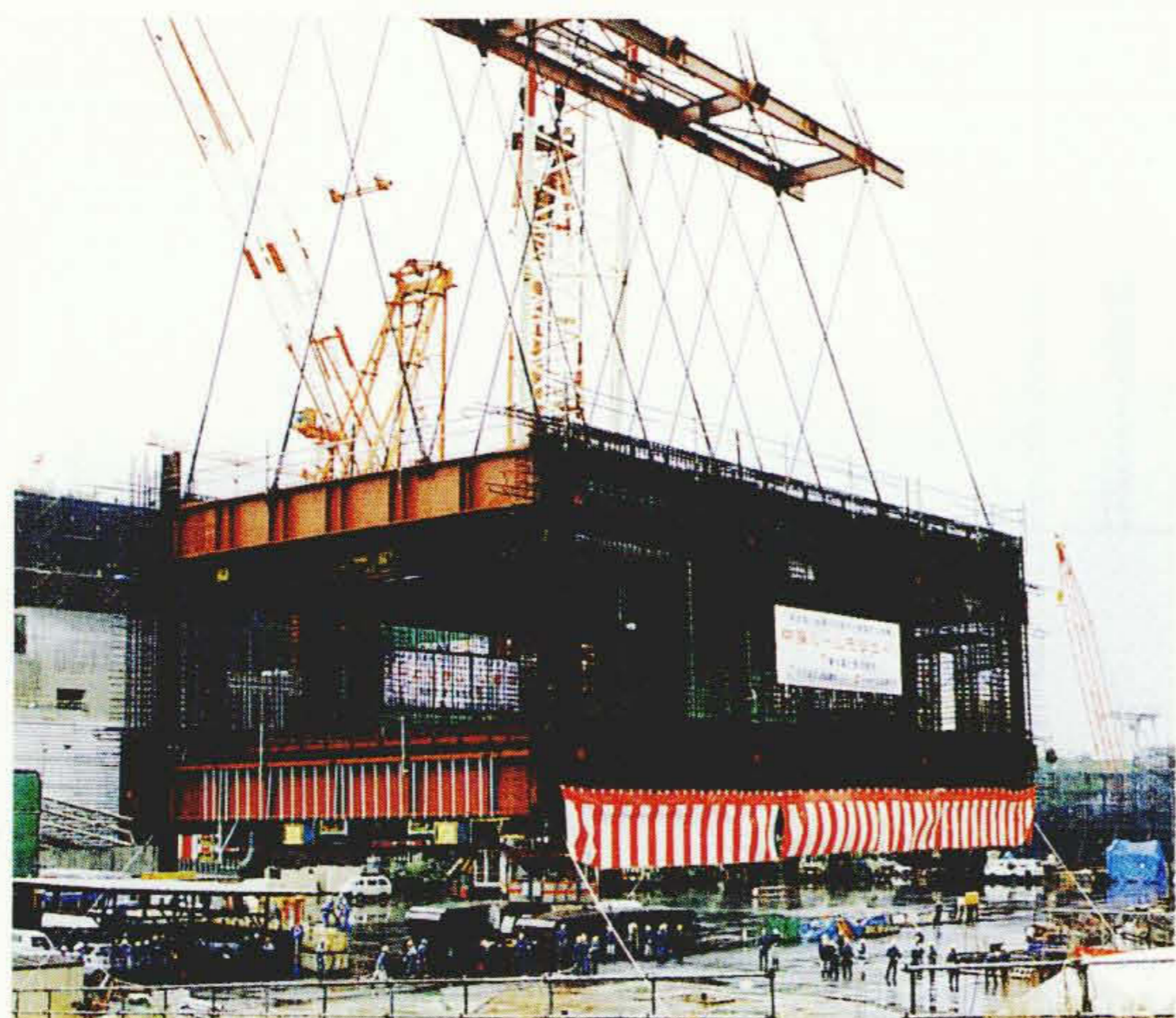
図7 中央制御室ルームモジュール
