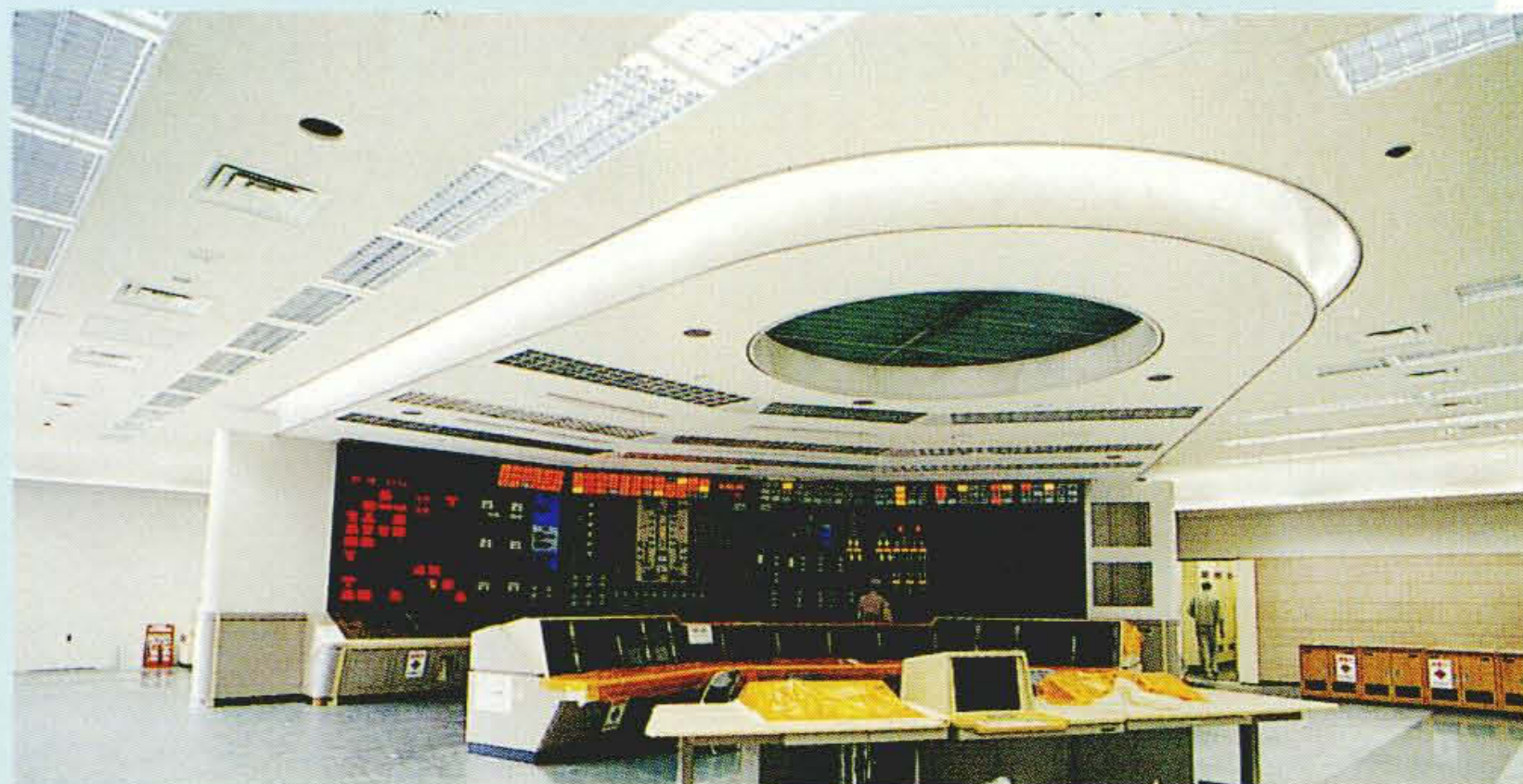
7号機中央制御盤
