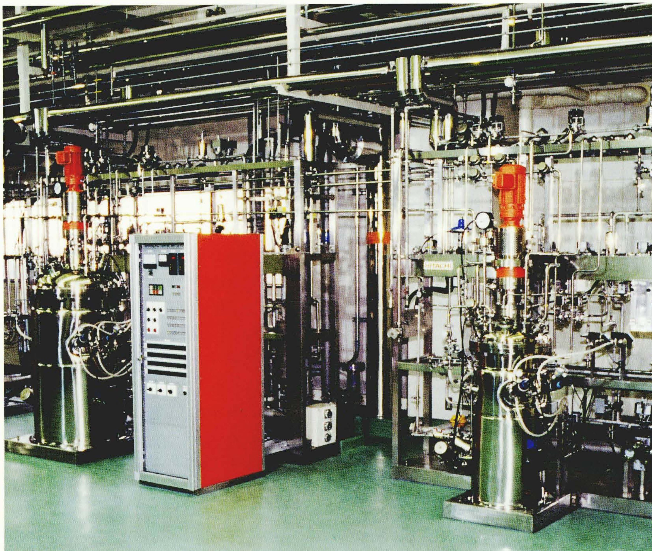
ヘキストジャパン株式会社納め動物細胞培養プラント このプラントではGMP(Good Manufacturing Practice)対応として各バリデーションを行った。
