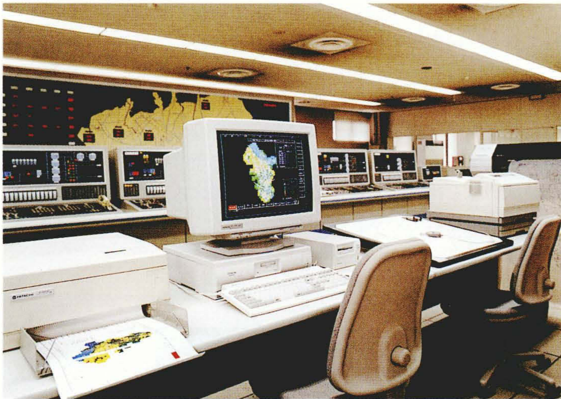
柏市水道部納め配水コントロールシステム
