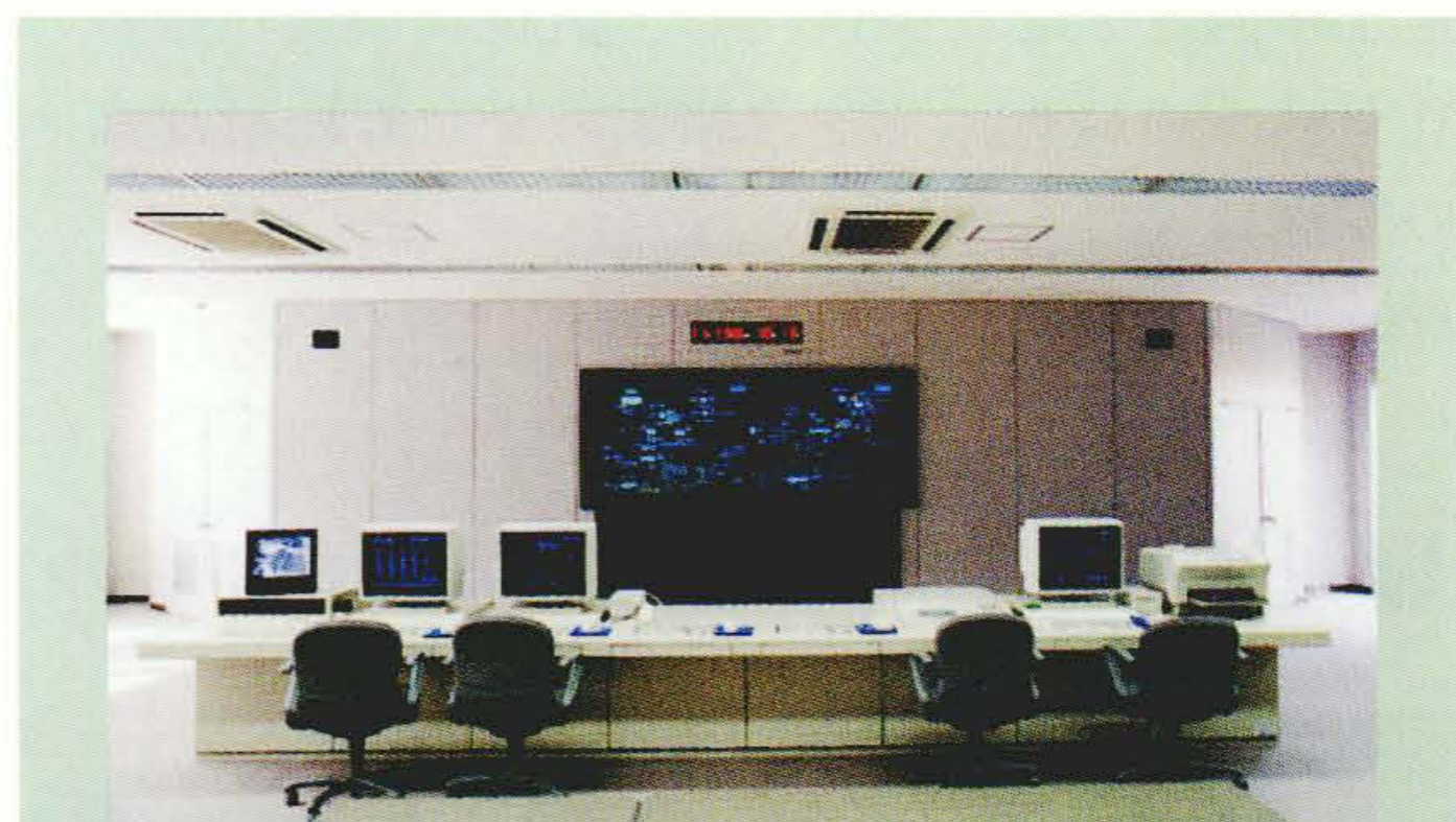
配水管理センター監視室
