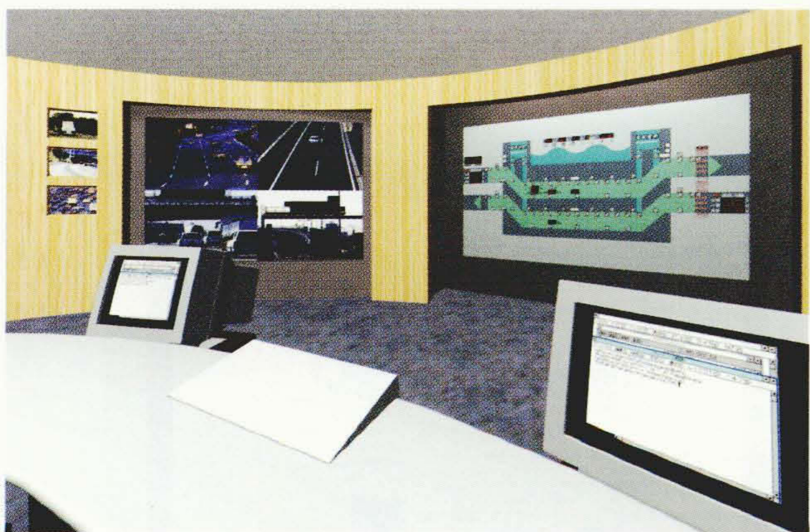
トンネル施設管制室
