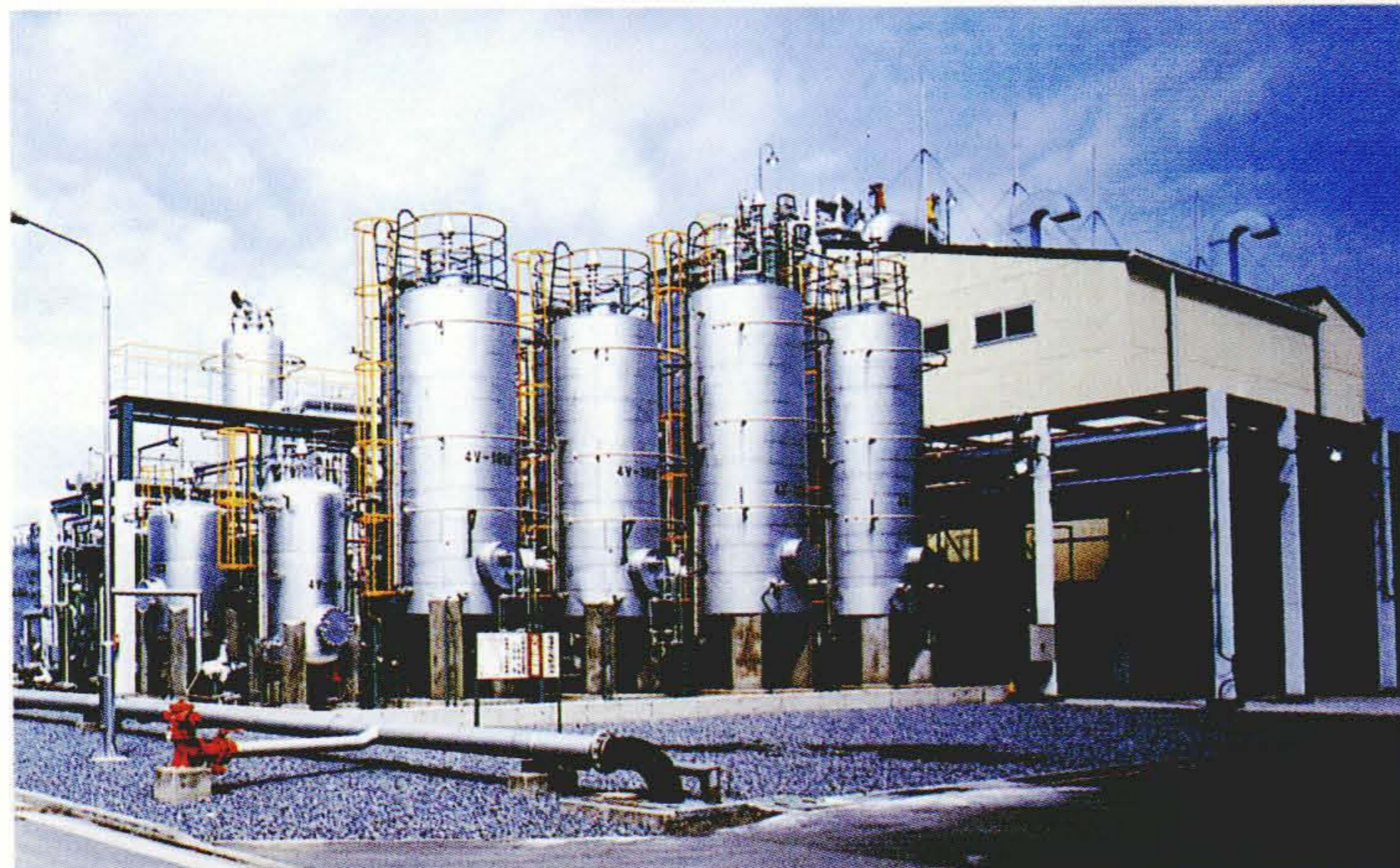
電気化学工業株式会社千葉工場の最新ポリスチレンプラント
