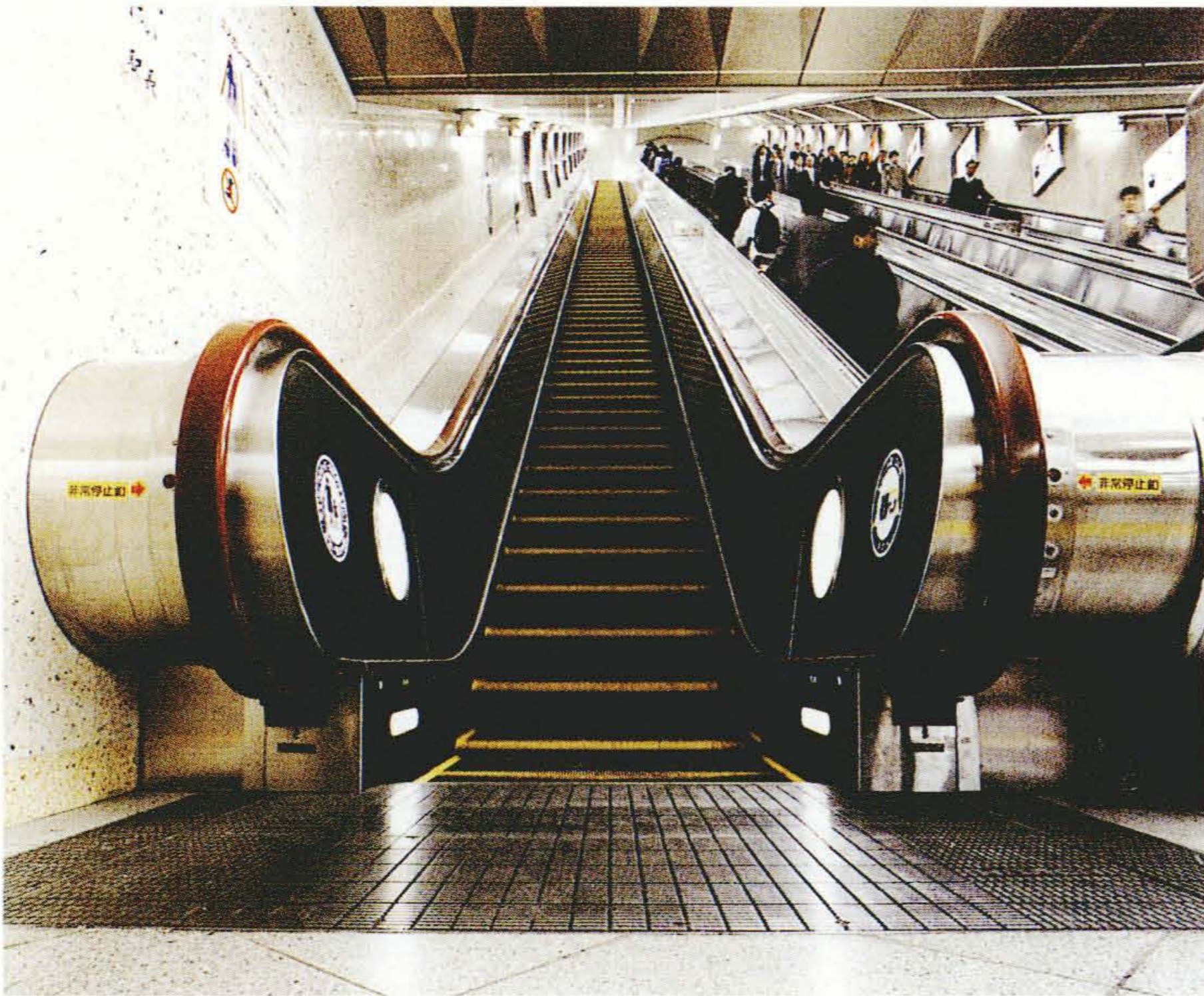
機能・意匠を一変した新御茶ノ水駅納めエスカレーター
