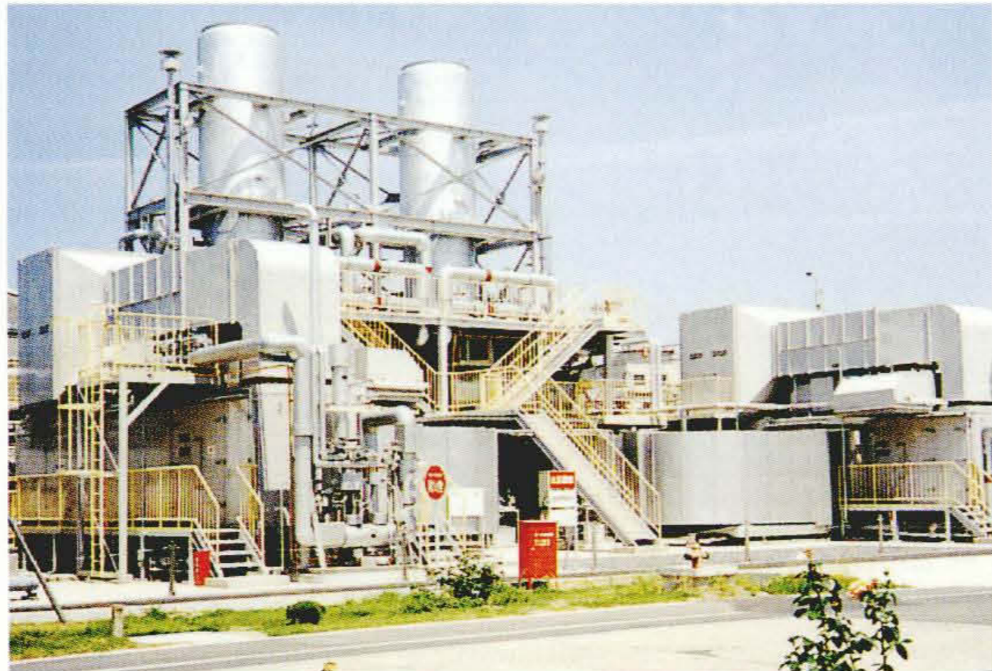
7,100 kWガスタービン コージェネレーション システム
