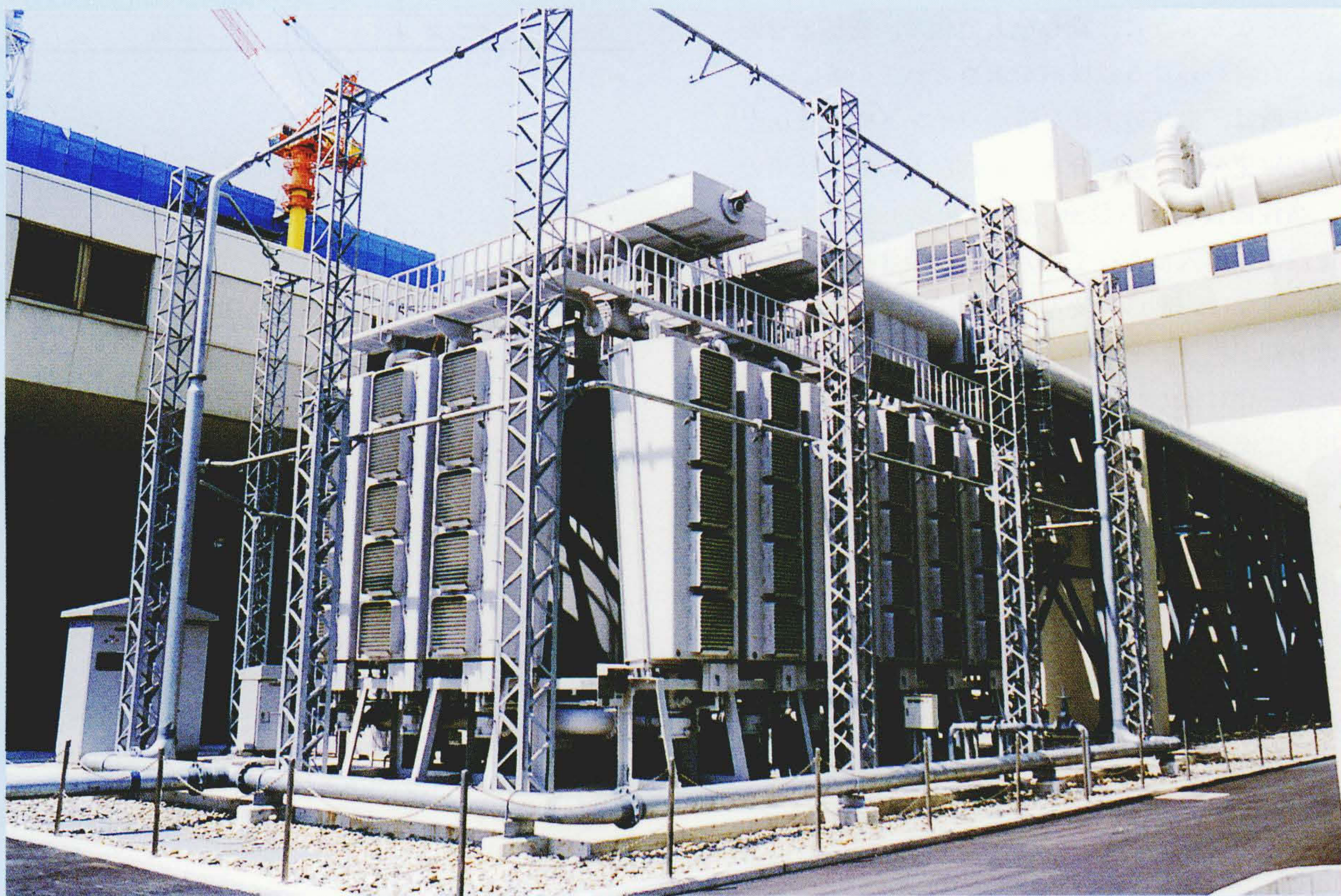
525 kV 1,450 MVA三相変圧器の外観
