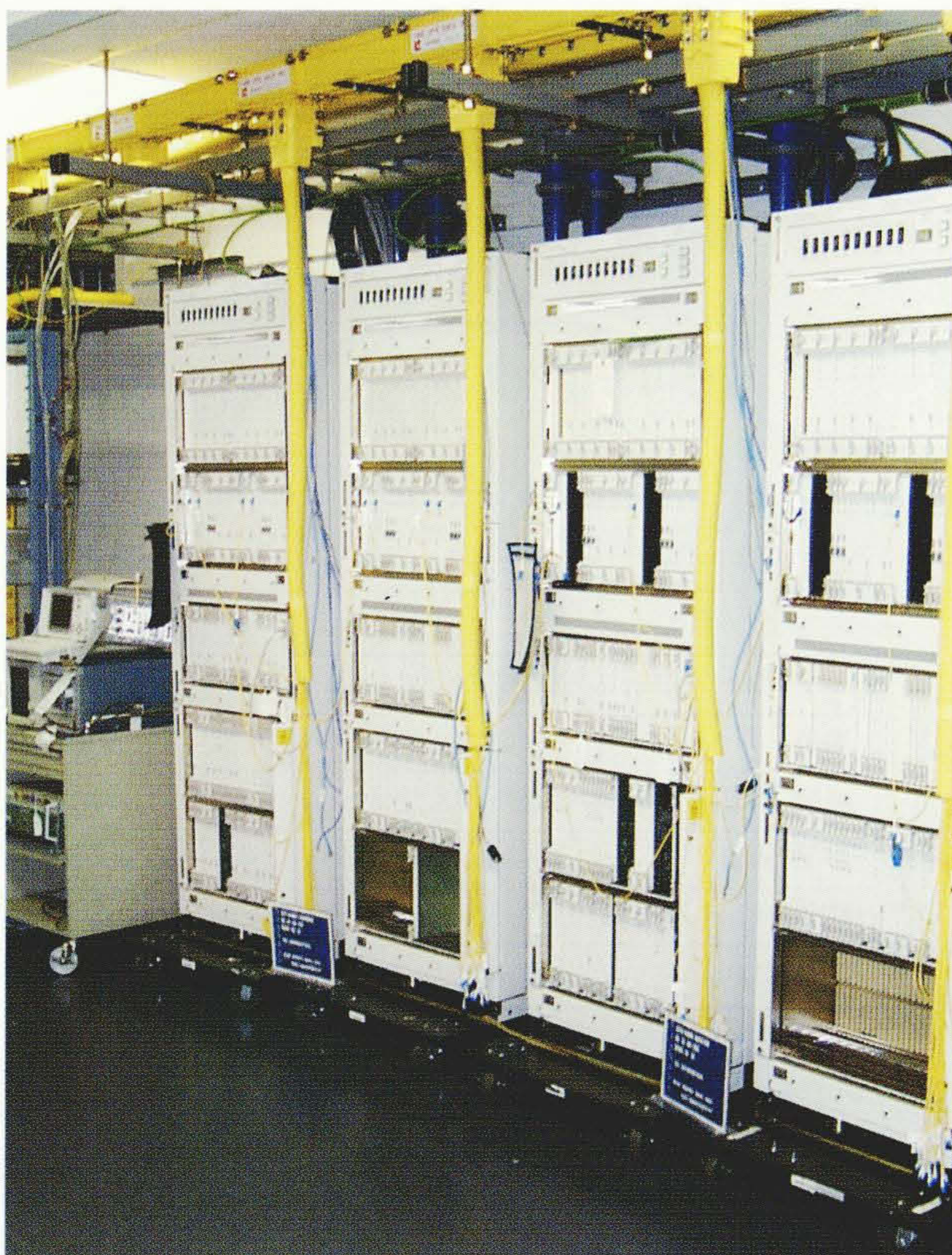
北米向けのSONET OC-192(10 Gビット/s)光ネットワーク・トランスポートシステム
